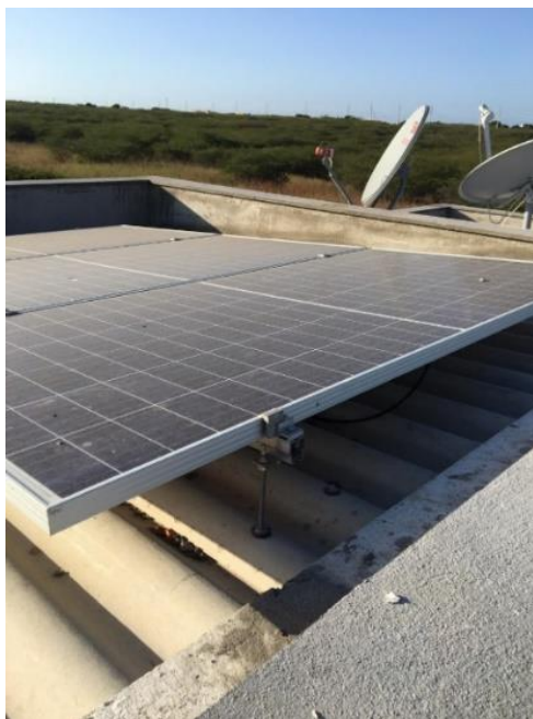
Figura 24 - Estrutura de suporte no telhado
