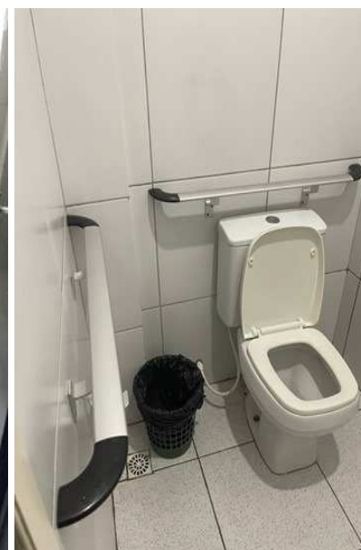
FIGURA 17: Banheiro dos alunos da Creche Municipal São José.
