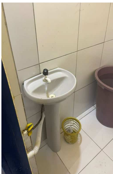
FIGURA 18: Torneira não acionada por alavanca ou sensor da Escola Creche Mundo Feliz.
