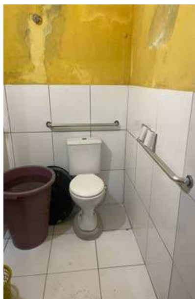
FIGURA 15: Banheiro Sem barra de apoio horizontal da Escola Creche Mundo Feliz.
