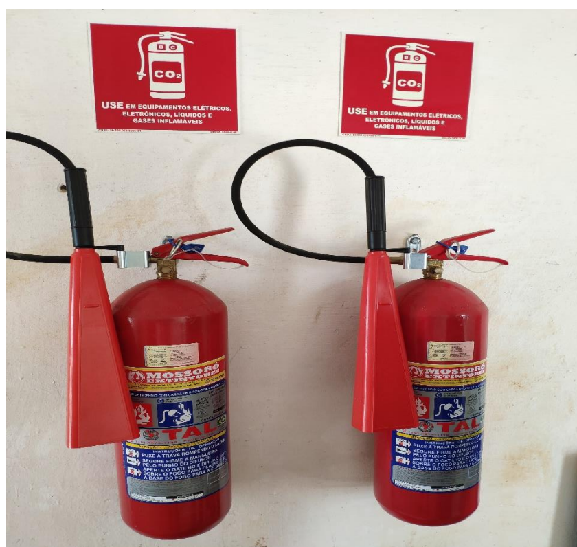
Figura 16 - Extintores presentes na Câmara
