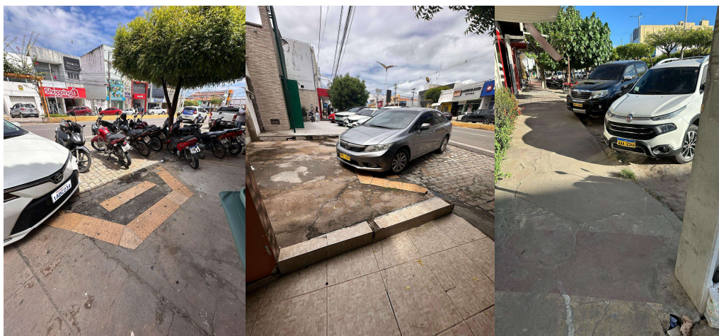
Figura 12 - Obstrução de rampa de acesso à passeio.
