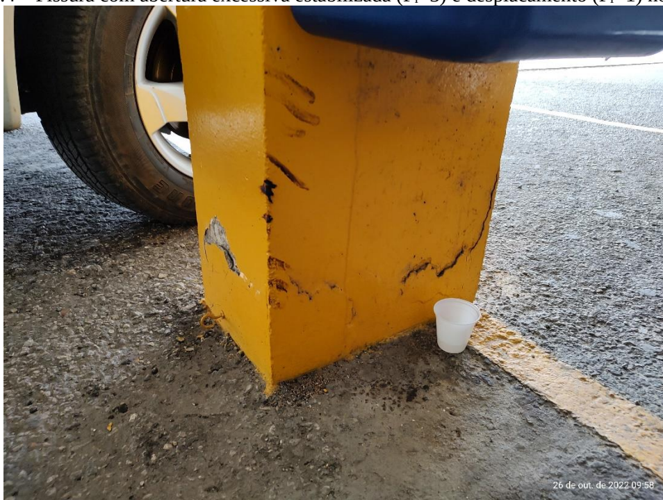
Figura A.4 – Fissura com abertura excessiva estabilizada ( F_i=3 ) e deslocamento ( F_i=1 ) no pilar P78
