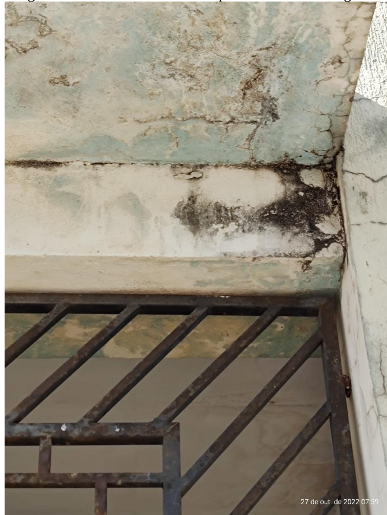
Figura A.5 – Manchas escuras de pouca extensão na viga V1
