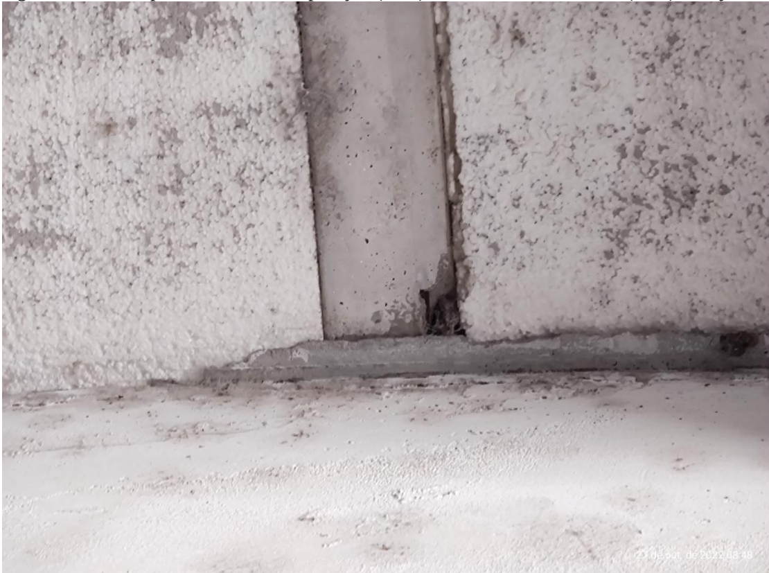
Figura A.10 – Desplacamento com exposição ( F_i=3 ) e corrosão da armadura ( F_i=2 ) na laje L12
