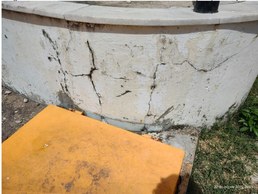
Figura A.13 – Fissuras com aberturas excessivas estabilizadas ( F_i=3 ) na rampa R3
