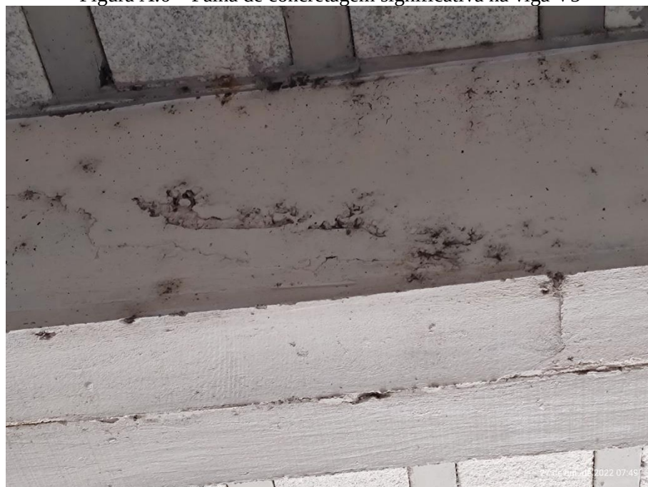
Figura A.6 – Falha de concretagem significativa na viga V5
