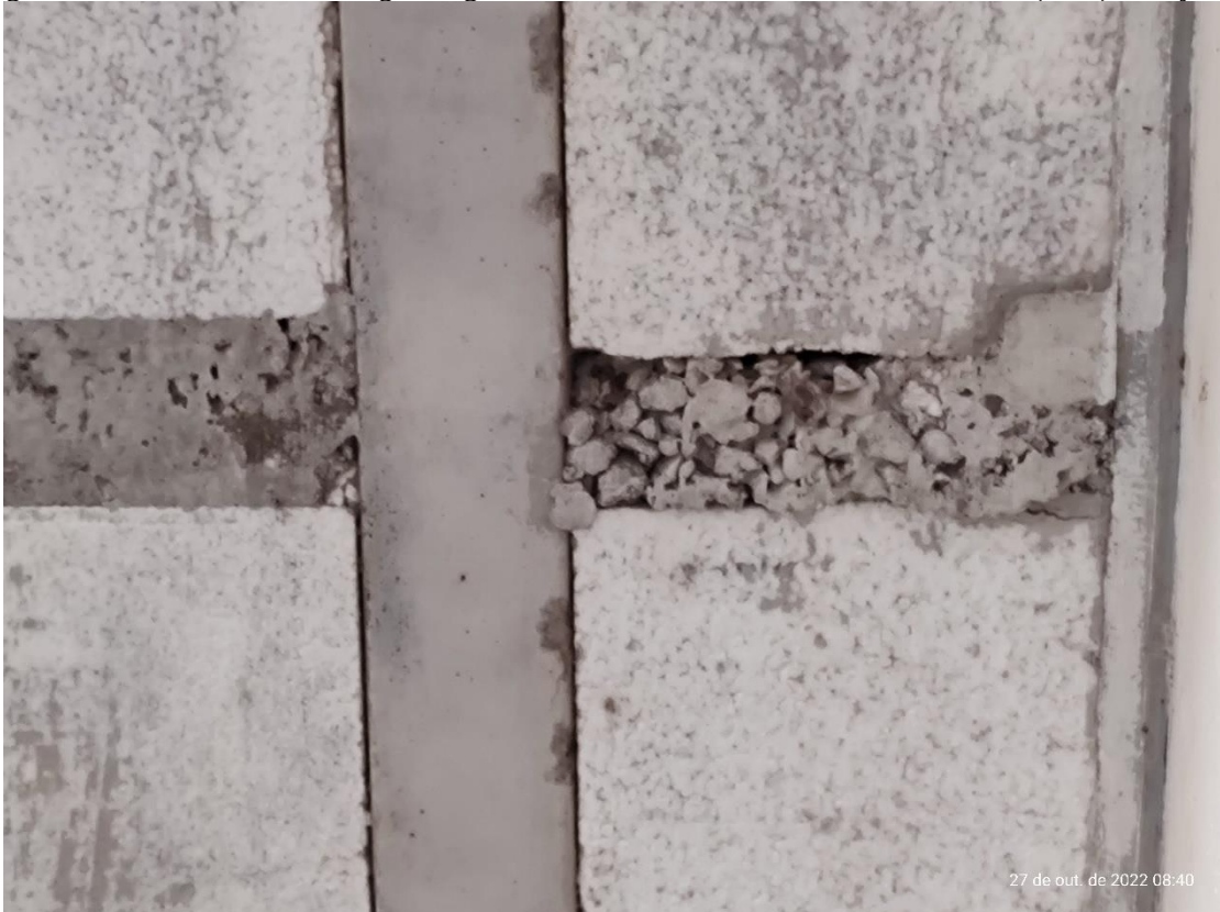
Figura A.9 – Falha de concretagem significativa deixando a armadura vulnerável ( F_i=3 ) na laje L6
