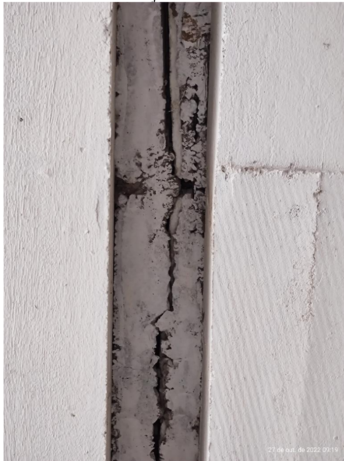
Figura A.14 – Presença de material não compressível na junta ( F_i=3 ) e desgaste do material ( F_i=2 ) na junta J4
