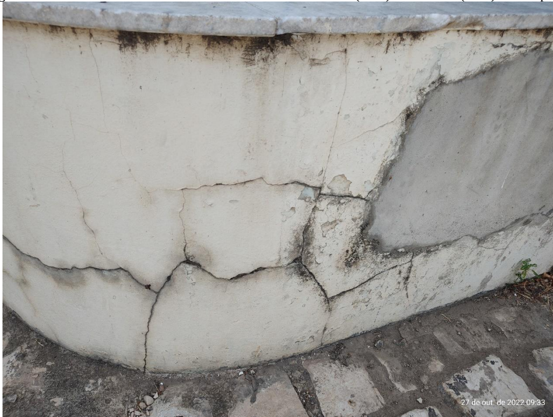
Figura A.11 – Fissuras com aberturas excessivas estabilizadas ( F_i=3 ) e manchas ( F_i=2 ) na rampa R1
