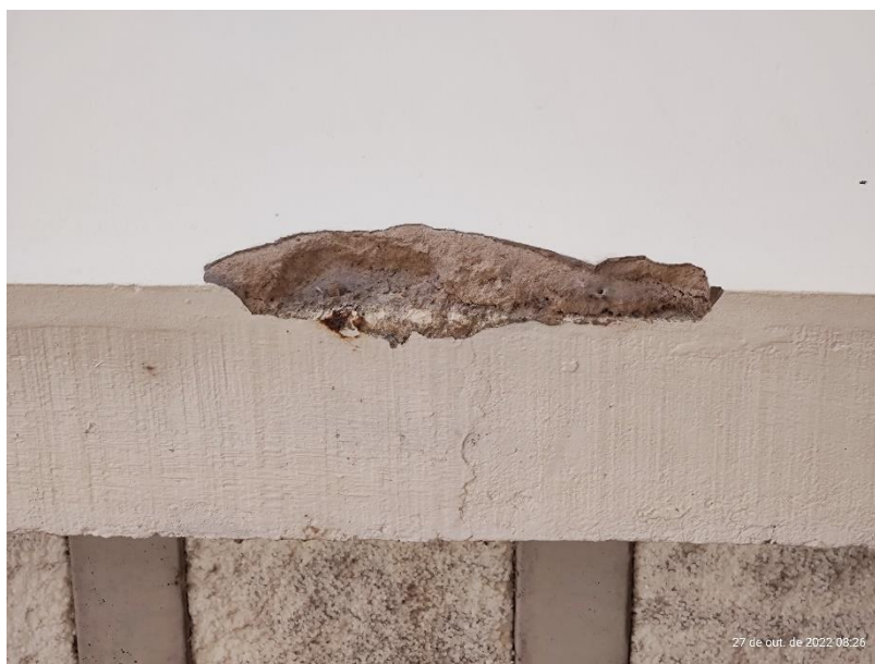
Figura 18 – Desplacamento e corrosão da armadura da viga V32
