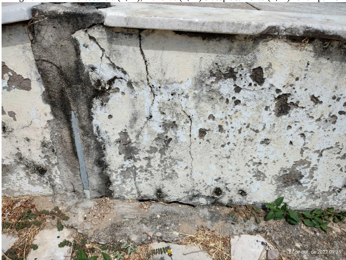
Figura A.12 – Eflorescência ( F_i=2 ), manchas ( F_i=2 ) e deslocamento ( F_i=2 ) na rampa R3
