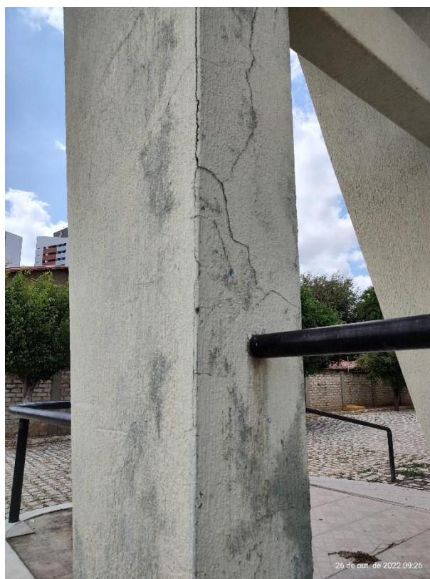
Figura 15 – Fissuras e manchas presentes no pilar P7
