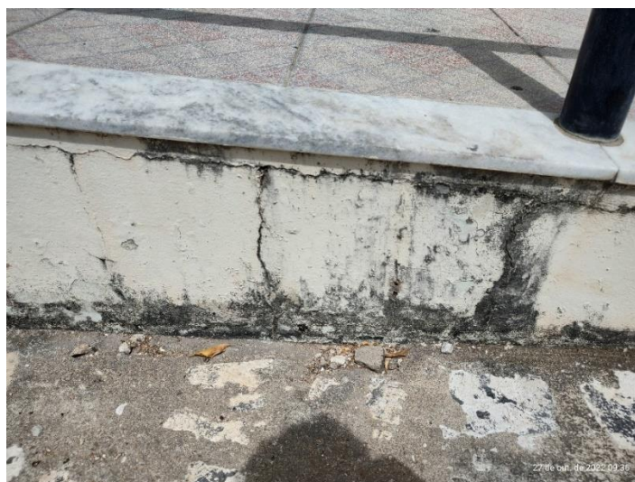
Figura 22 – Manchas escuras e eflorescência na rampa R4
