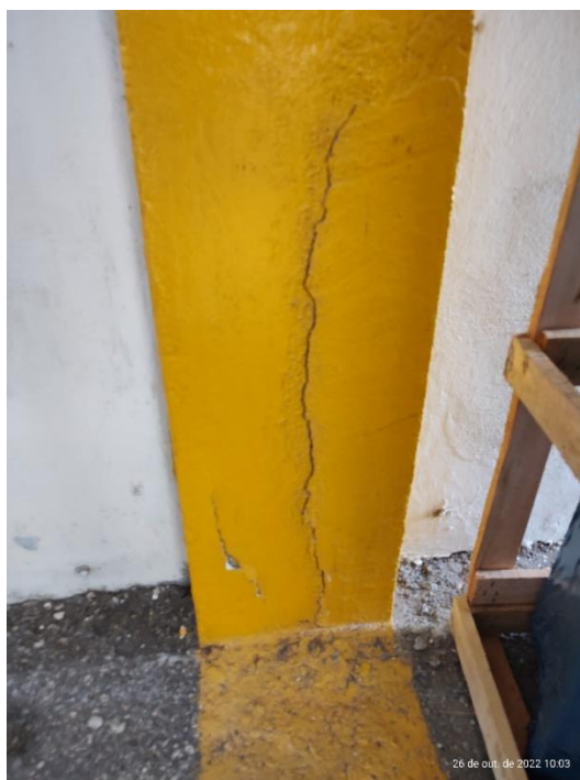
Figura 17 – Fissura no pilar P74
