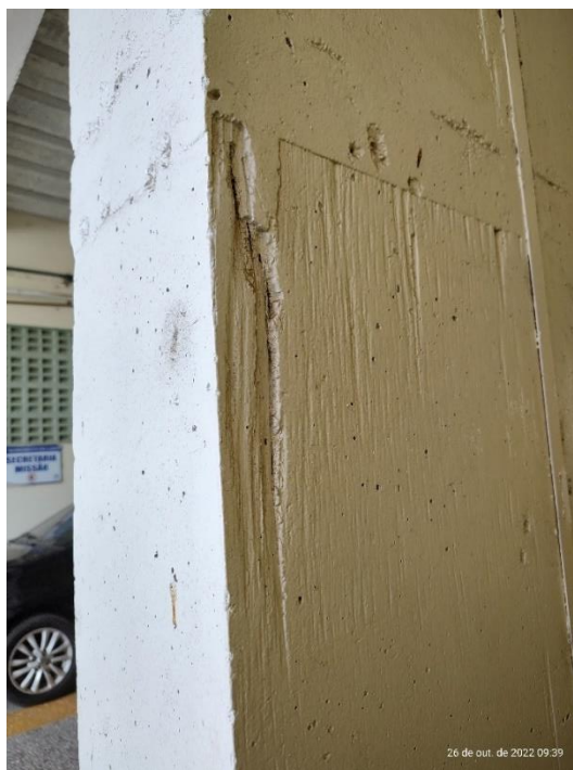
Figura 16 – Falhas de concretagem e deslocamento no pilar P45
