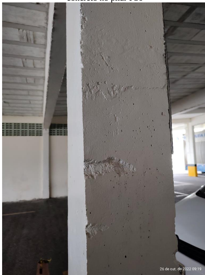
Figura A.3 – Falha de concretagem superficial ( F_i=1 ) e deslocamento com pequenas escamações do concreto no pilar P30
