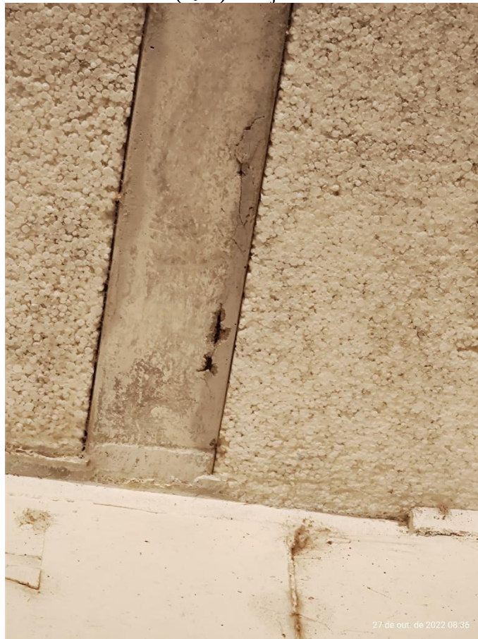
Figura A.8 – Desplacamento com exposição da armadura ( F_i=3 ) e corrosão com pequenas manchas ( F_i=2 ) na laje L3
