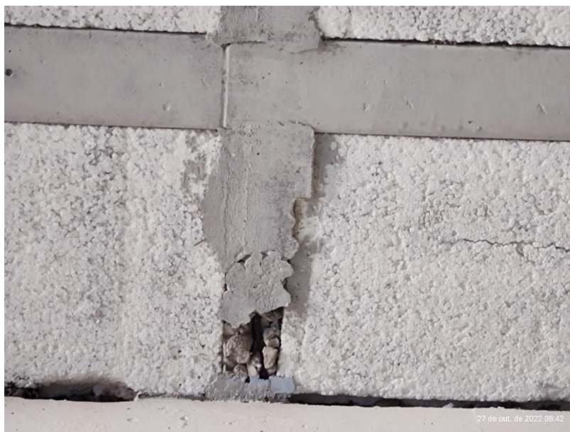
Figura 21 – Falha de concretagem na laje L10
