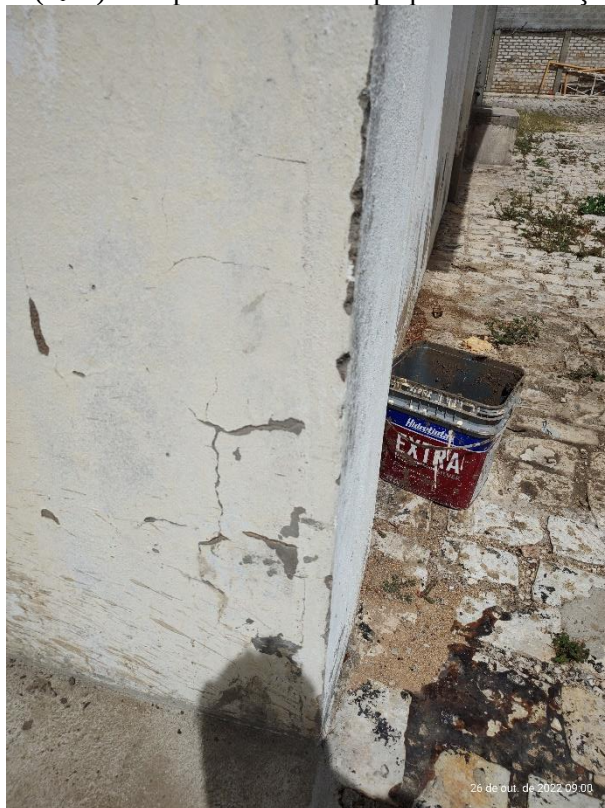
Figura A.1 – Fissuras ( F_i=1 ) e deslocamento com pequenas escamações ( F_i=2 ) do pilar P4
