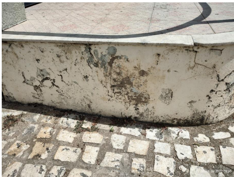
Figura 23 – Fissuras e deslocamento na rampa R4
