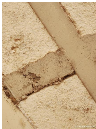
Figura D.2 – Falha de concretagem na laje 02
