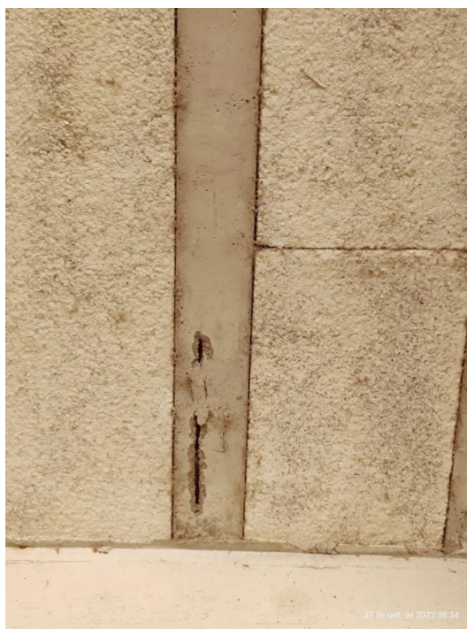
Figura 19 – Desplacamento e corrosão de armadura da laje L2
