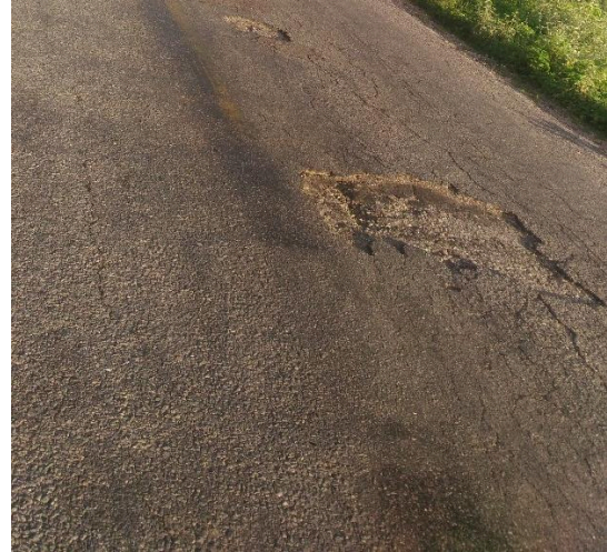
Figura 4.9- Buracos ou Panelas
