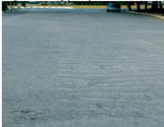
Figura 3.12 - corrugação em pavimento, DNIT (2003)
