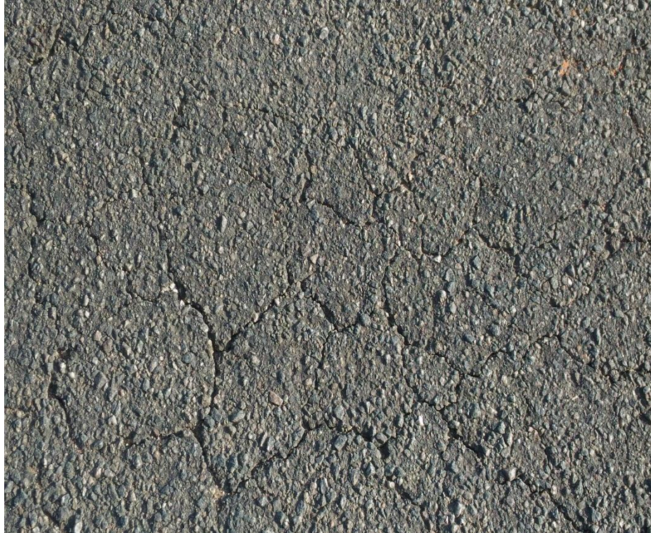
Figura 4.6 - Trincamento por Fadiga
