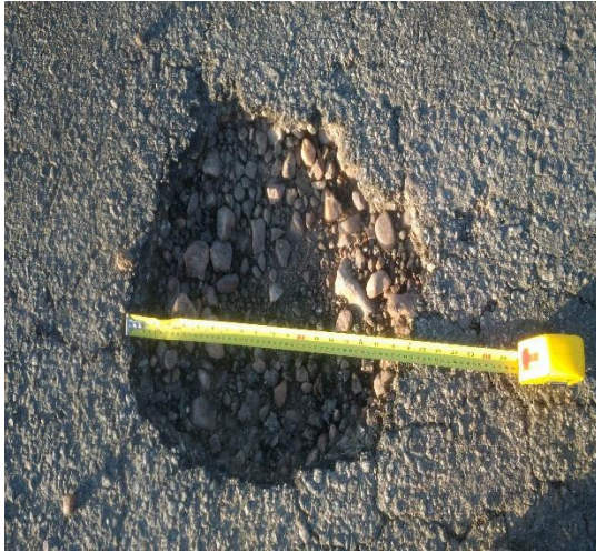
Figura 4.8- Buracos ou Panelas
