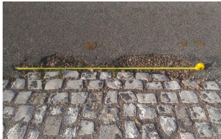
Figura 4.10- Buracos ou Panelas
