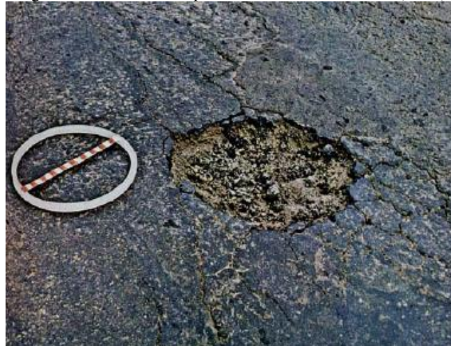
Figura 3.13- Panela em pavimento asfáltico, DNIT (2003)
