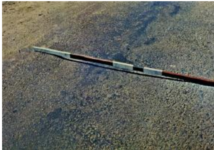
Figura 3.10- Afundamento de pavimento, DNIT(2003)
