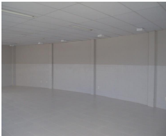
Figura 33 – Imagem dos pilares sobressaindo à parede no auditório.
