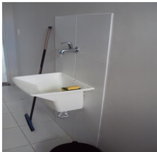
Figura 37 – Imagem de um tanque de lavar instalado no depósito.
