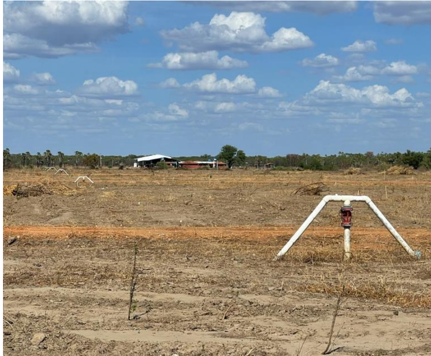
FIGURA 2: Válvulas do sistema de irrigação existente.
