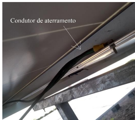
Figura 14. Conexão da estrutura do módulo com o condutor de aterramento. (Autoria Própria, 2019)
