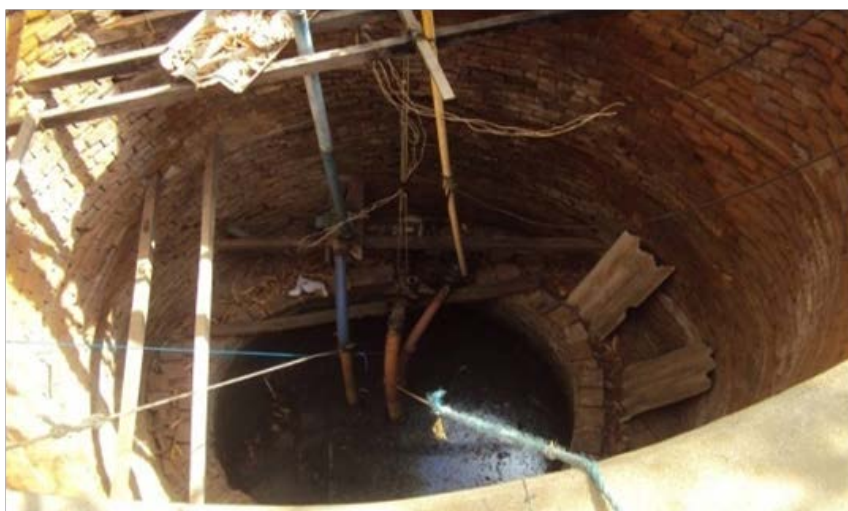
Figura 4- Poço de abastecimento da área.
