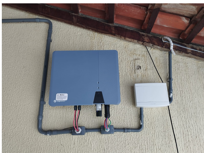
Figura 7. Divisão da instalação e ausência de Identificação. (Fonte: Autor).
