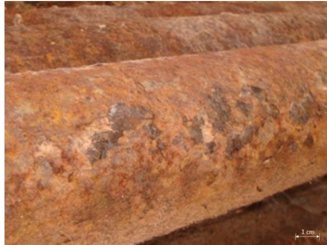
Figura 22 - Corrosão por placas em superfície externa de tubo API 5L GrB
