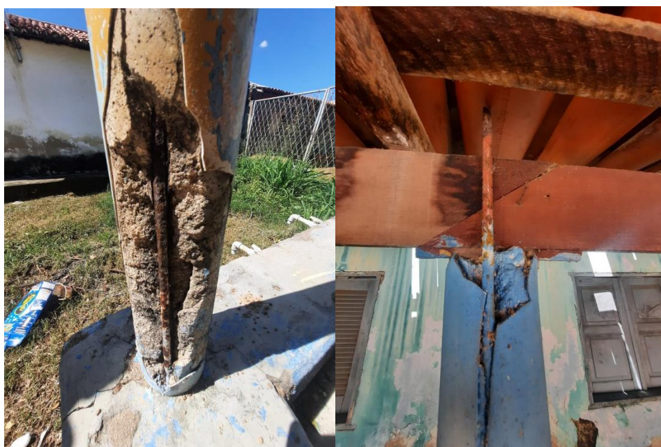
Figura 11: Pilares em Corrosão.
