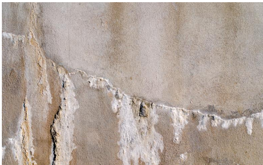
Figura 6: Eflorescência no Concreto.
