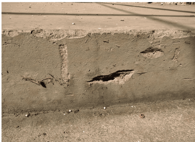
Figura 4: Desplacamento no Concreto.
