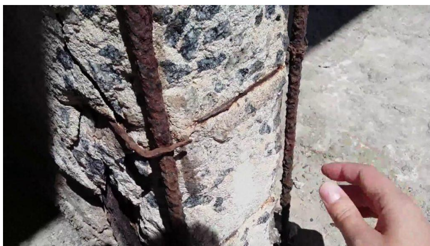
Figura 2: Corrosão das Armaduras.
