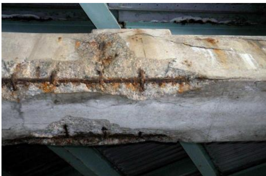
Figura 5: Carbonatação no Concreto.
