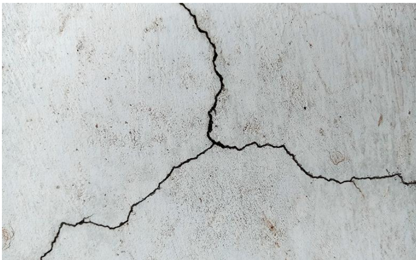
Figura 3: Fissuras no Concreto.
