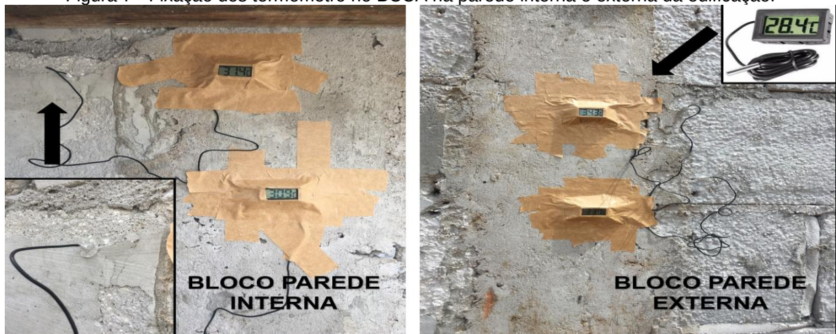
Figura 7 - Fixação dos termômetro no BCCA na parede interna e externa da edificação.
