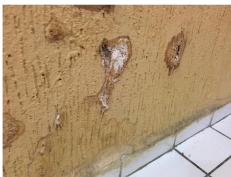
Figura 1 – Ocorrência de eflorescências.
