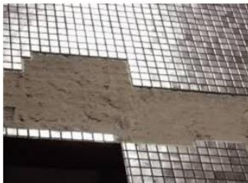
Figura 7 - Desplacamento cerâmico em fachada.
