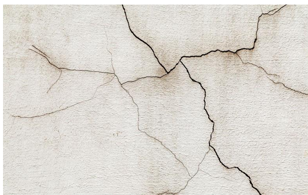
Figura 4 – Fissuras em parede.
