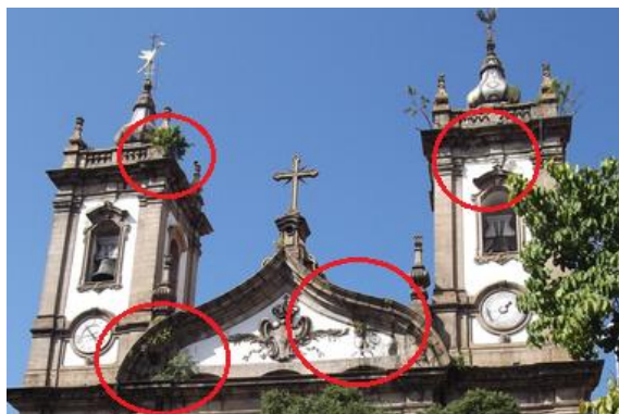
Figura 8 - Vida vegetal em edificações.
