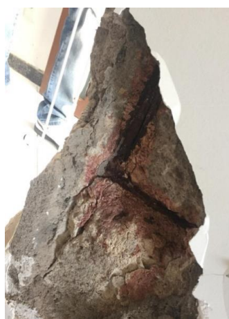
Figura 3- Ocorrência de corrosão nas armaduras.
