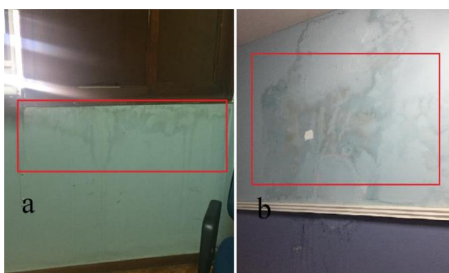
Figura 19 – Problema de umidade por infiltração, em a) sala dos bombeiros e b) corredor.
