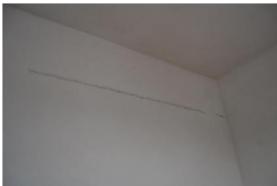
Figura 6 - Presença de fissuras horizontais.
