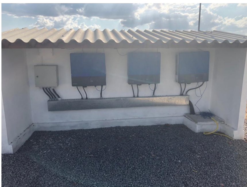
Figura 14: Inversores da usina Campus Pau dos Ferros.
