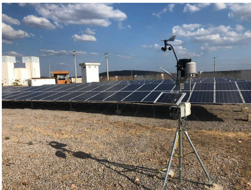
Figura 13: Usina solar fotovoltaica da UFERSA Campus Pau dos Ferros.
