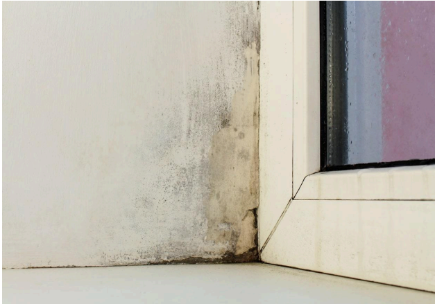
Figura 4 - Manchas no revestimento
