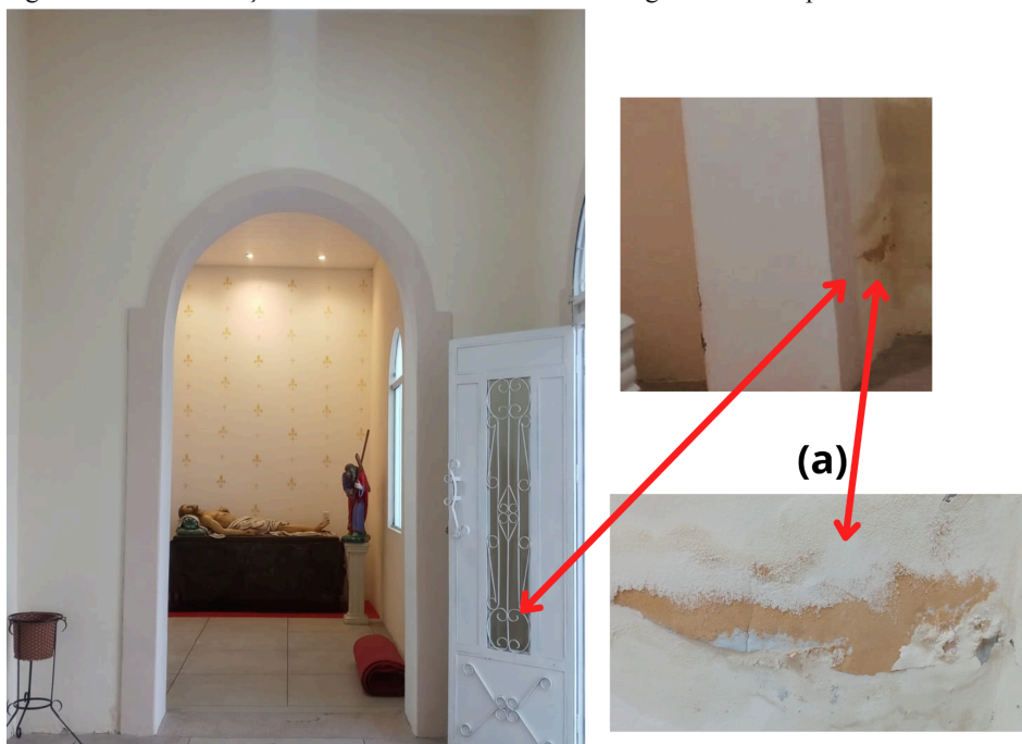
Figura 16 – Manifestações encontradas no revestimento argamassado da porta de acesso à sala à direita da torre.
