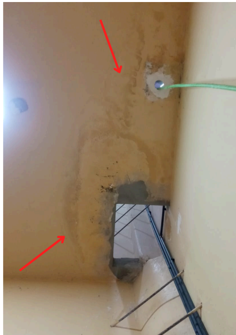
Figura 22 – Manchas de umidade no teto do primeiro pavimento
