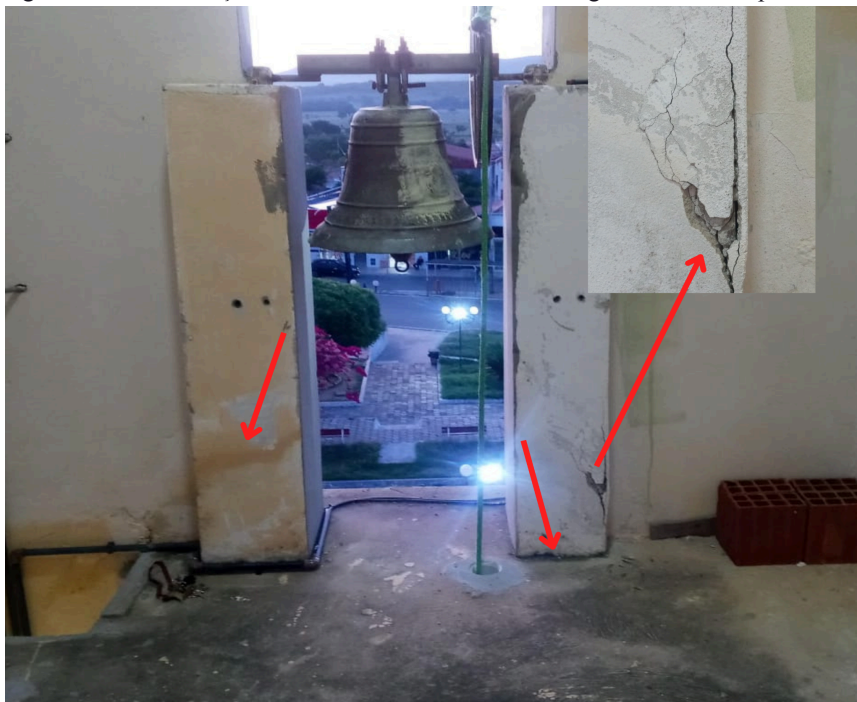
Figura 23 - Manifestações encontradas no revestimento argamassado de suporte do sino no segundo pavimento.
