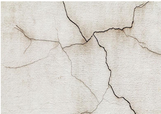
Figura 3 - Fissuras no revestimento argamassado.
