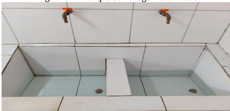
Figura 04 – Tanque de Lavagem das Frutas
