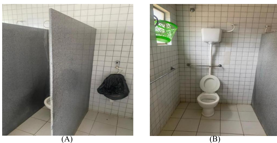
Figura 17 – Mictório danificado (A) e banheiro padrão (B) da Escola E
