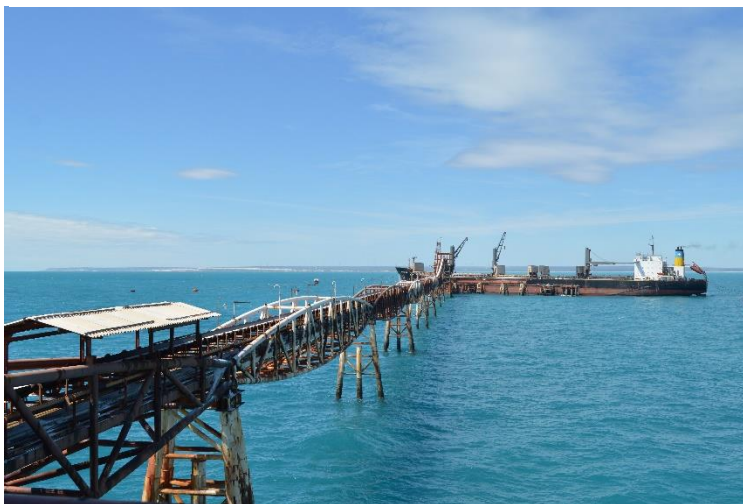
Figura 1 - Terminal Salineiro de Areia Branca
