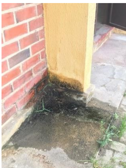
Figura 2: Infiltração na base de um pilar
