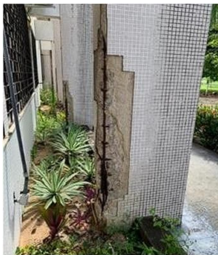
Figura 6: Corrosão de armaduras
