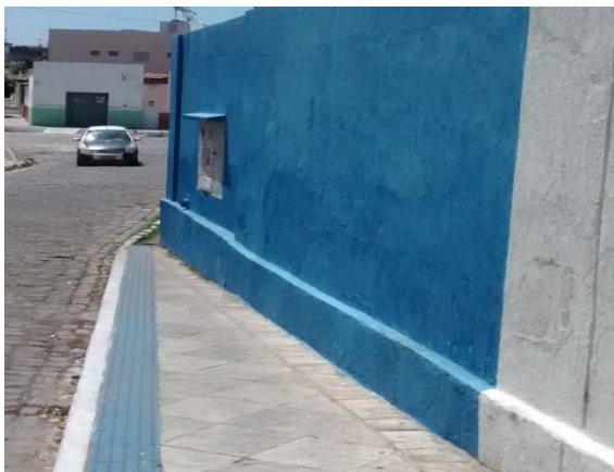
Figura 3: Calçada com dimensionamento insuficiente para a circulação de pedestres-Centro de Pau dos Ferros-RN.
