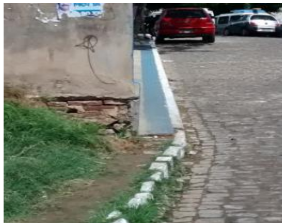
Figura 4: Calçada com dimensionamento insuficiente para a circulação de pedestres-Centro de Pau dos Ferros-RN.
