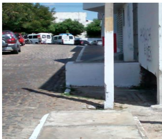
Figura 38: Falta de acessibilidade na calçada aliada a instalação incorreta do mobiliário urbano – Centro de Pau dos Ferros-RN. Fonte: Acervo pessoal do autor, 2014.
