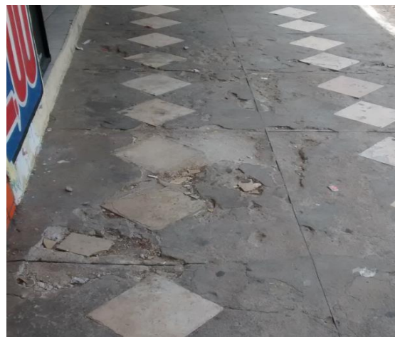
Figura 8: Calçada com superfície esburacada Utilização - Centro de Pau dos Ferros-RN. Fonte: Acervo pessoal do autor, 2014.
