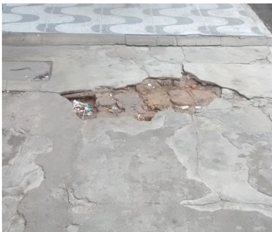
Figura 7: Calçada com superfície esburacada Utilização - Centro de Pau dos Ferros-RN. Fonte: Acervo pessoal do autor, 2014.
