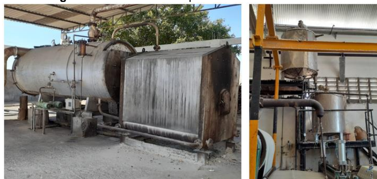
Figura 03 – Caldeiras e aquecedores de fluido térmico.
