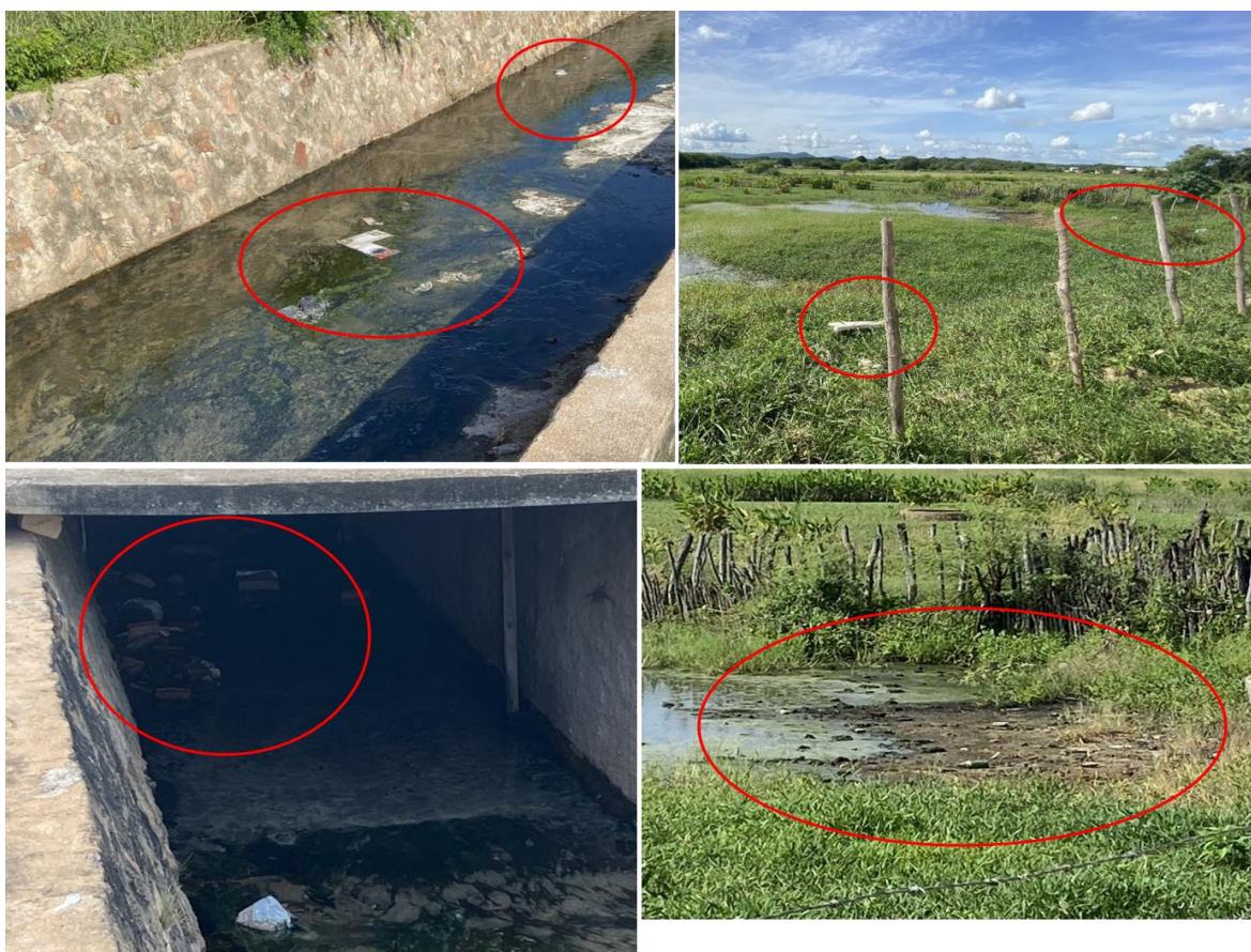
Figura 12 – Despejo de resíduos sólidos ao longo do canal de drenagem e reservatório.
