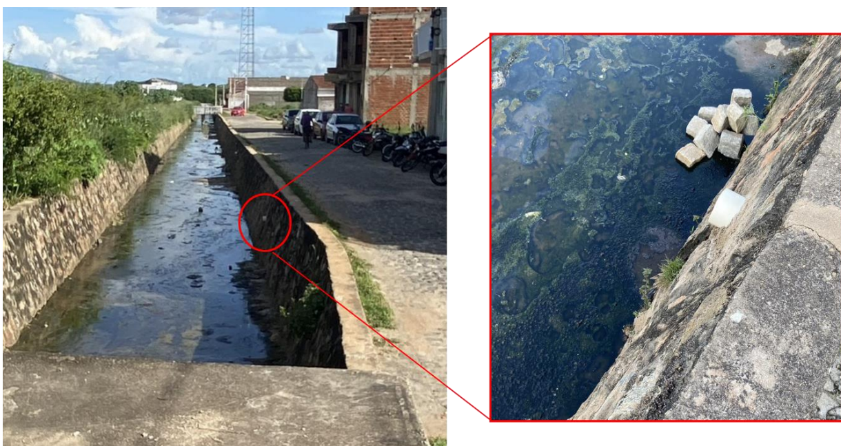
Figura 11 – Canal de drenagem recebendo despejo de esgotos domésticos.
