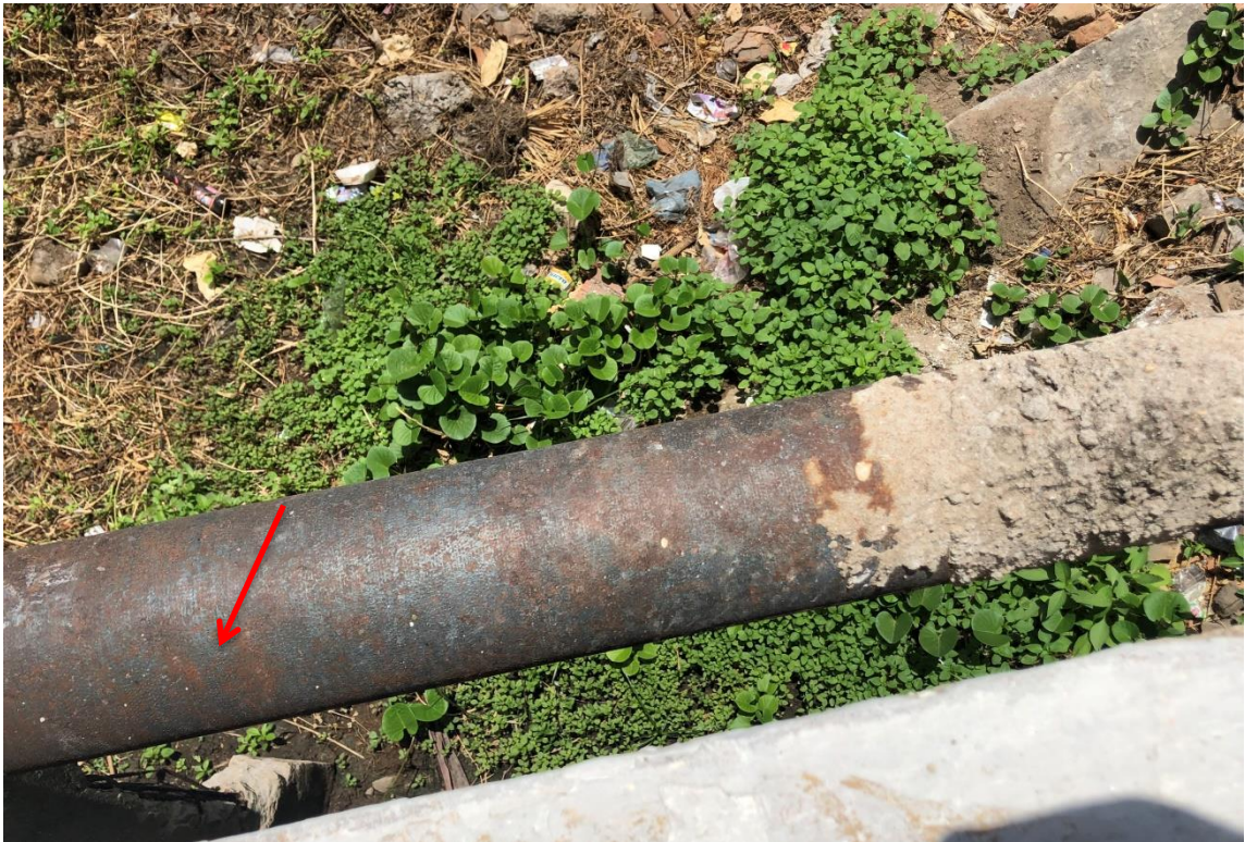
Figura 23: Tubulação parcialmente corroída.
