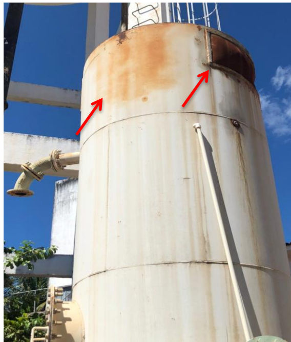
Figura 38: Reservatório em processo corrosivo em 2021.
