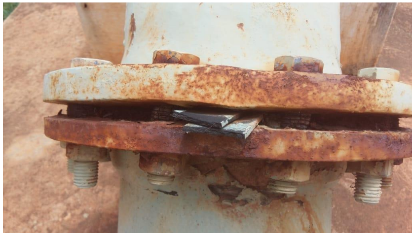
Figura 37: Peças de junção em processo corrosivo em 2019.
