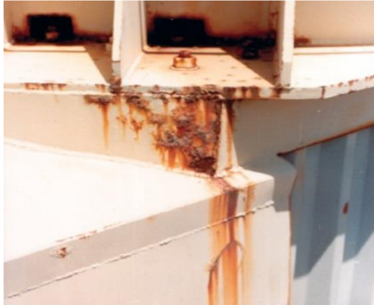
Figura 13: Corrosão por frestas.
