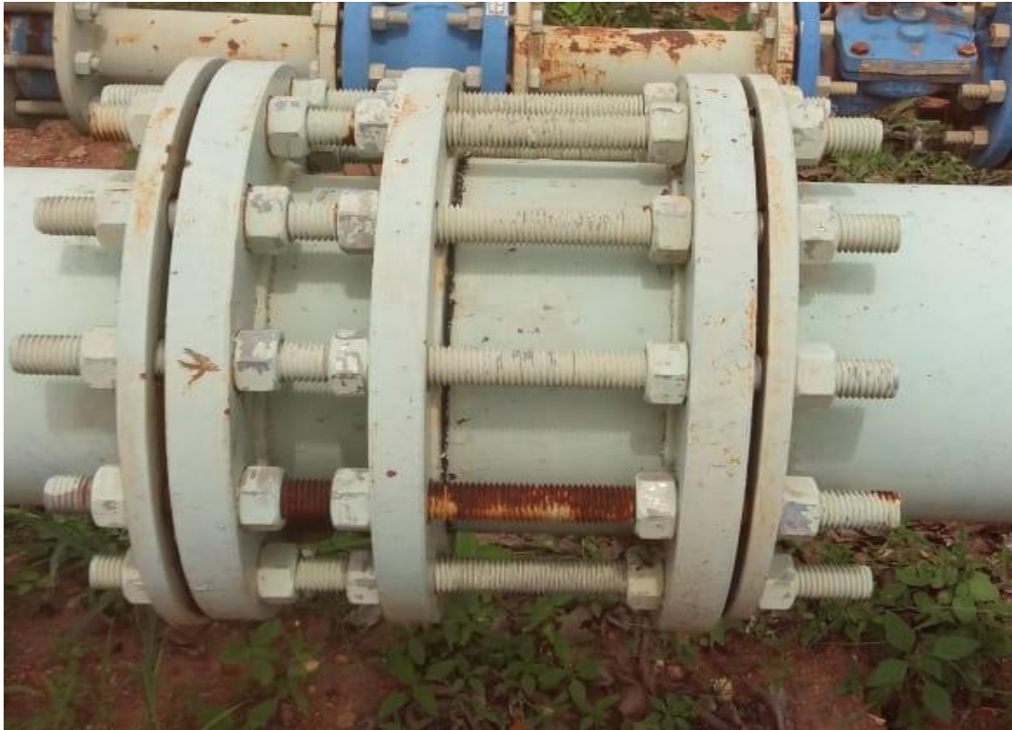
Figura 29: Parafusos de fixação em fase corrosiva.
