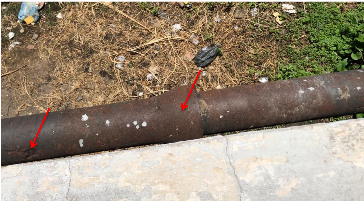
Figura 22: Tubulação de distribuição de água em ferro fundido.
