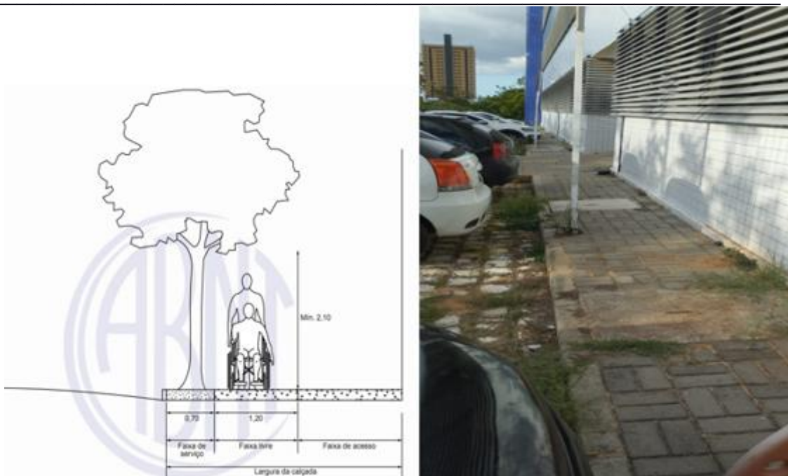
Figura 3. Calçadas externas sem largura necessária e com obstáculos (imagem NBR 9050/ foto autoria própria).
