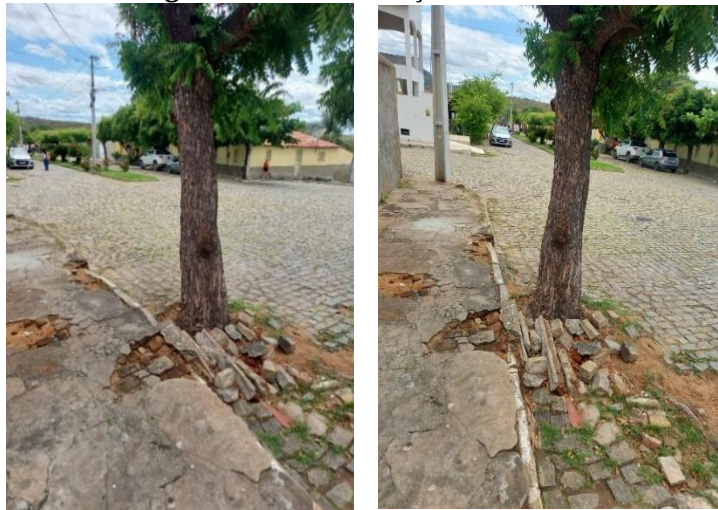
Figura 6 – Danos a calçadas no Bairro Novo Encanto
