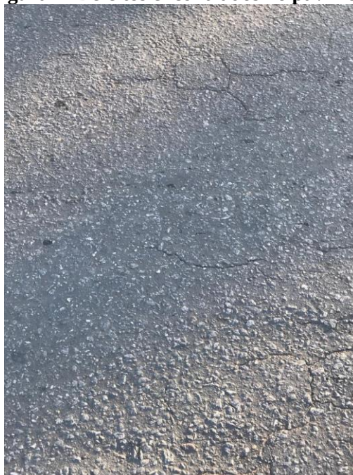
Figura 7- Defeitos encontrados no pavimento
