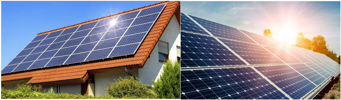
Figura 02: Painel fotovoltaico em telhado
