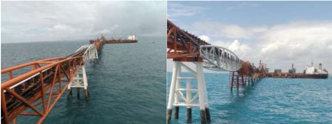
Figura 6 - Esteira transportadora e estrutura de sustentação
