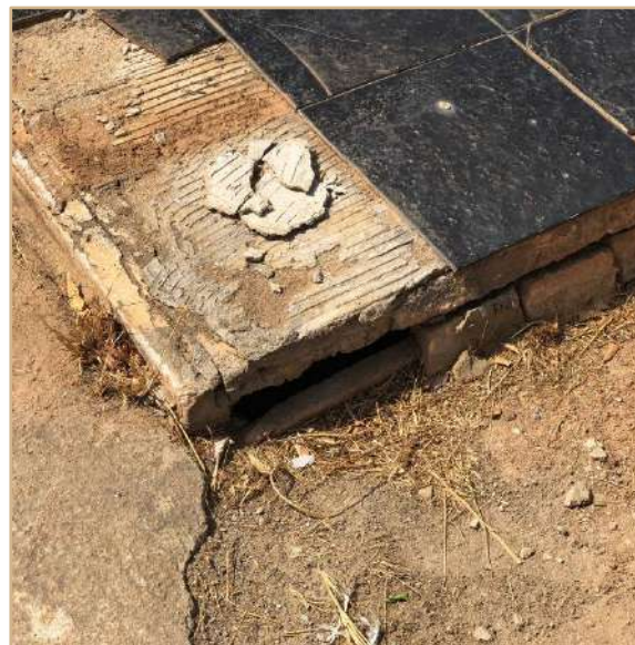
Figura 50 - Túmulo com Fissuras na Tampa e Espaços Abertos no Cemitério Parque da Saudade
