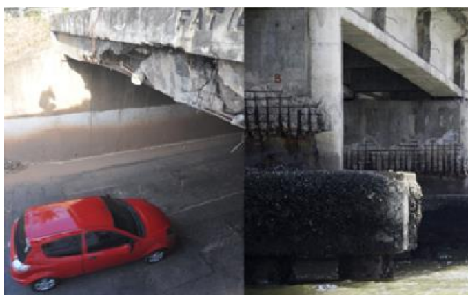
Figura 1: Concreto desgastado devido a corrosão química
