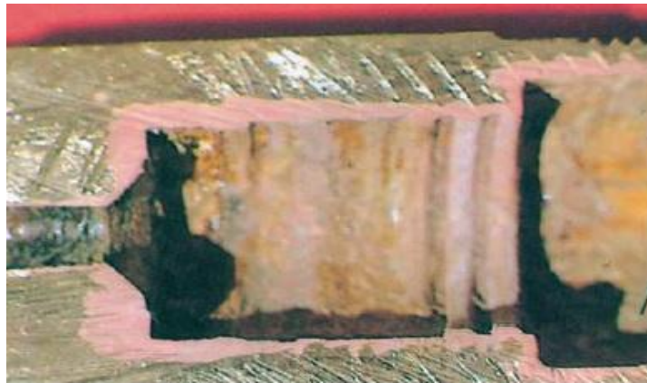
Figura 14: Corrosão por dezincificação
