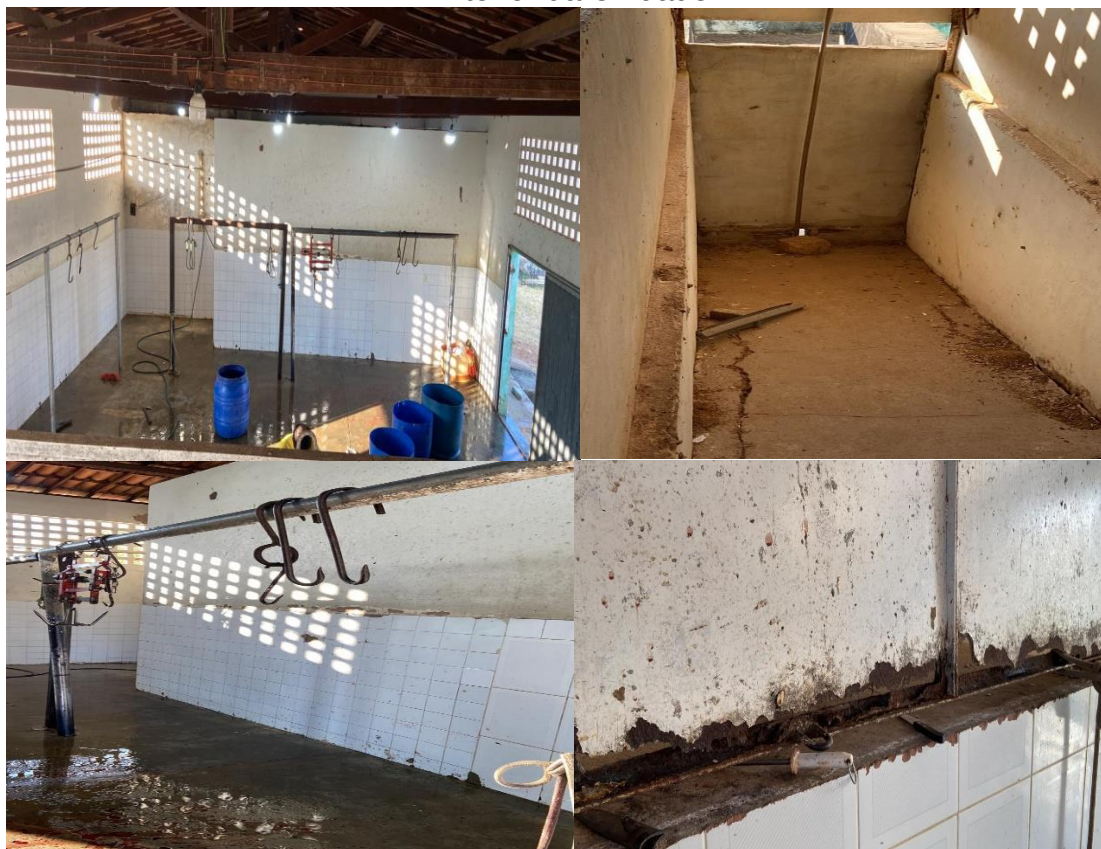
Figura 9: situação de desgaste das estruturas de concreto e suportes de aço no interior da Unidade.
