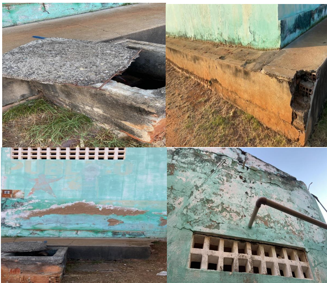
Figura 07 – Desgaste na estrutura de concreto e alvenaria na parte externa da Unidade.
