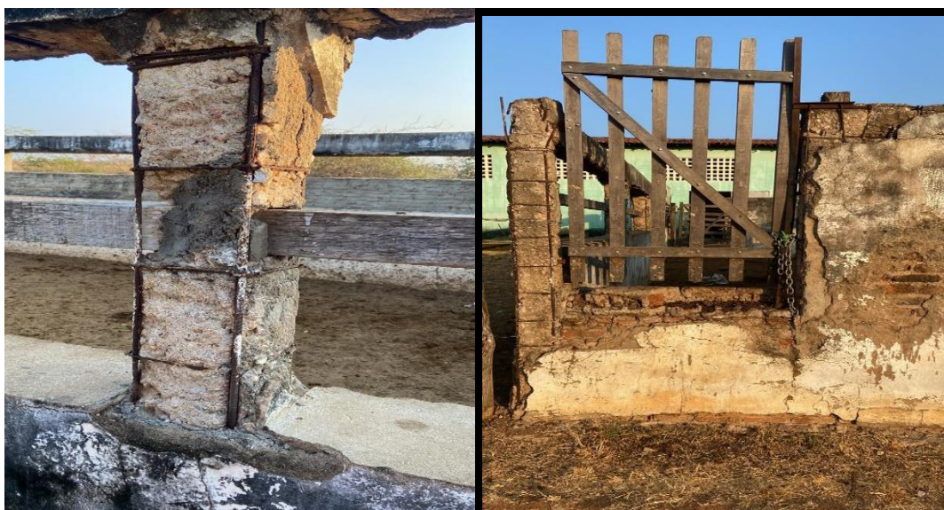
Figura 8: nível de desgaste das estruturas de concreto e alvenaria do curral do abatedouro público de José da Penha – RN.
