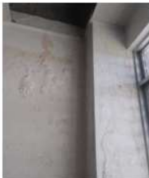
(d) Infiltração no Pilar, Teto e a Parede
