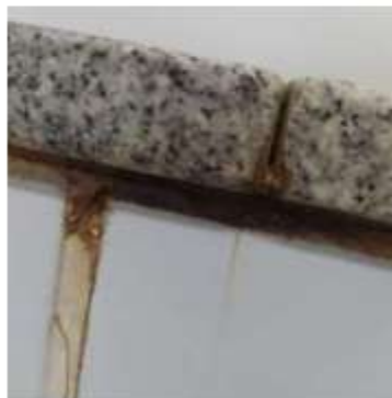
(e) Infiltração na Junta do Parapeito da Janela
