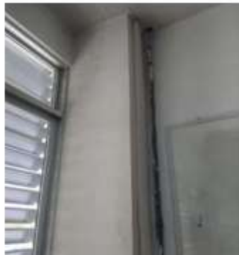
(b) Infiltração no Pilar e a Janela
