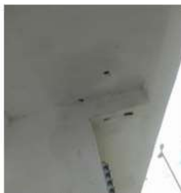
(b) Infiltração na laje e Viga
