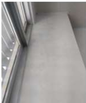
(a) Infiltração no Pilar e a Janela
