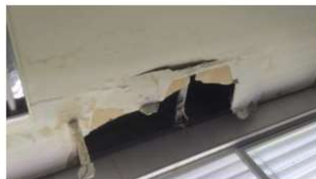
(e) Infiltração na Laje e Forro
