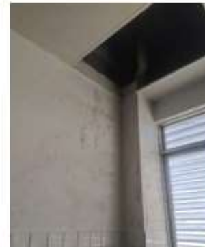
(c) Infiltração no Pilar, Teto e a Parede
