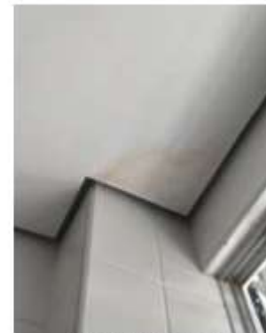
(c) Infiltração no Forro
