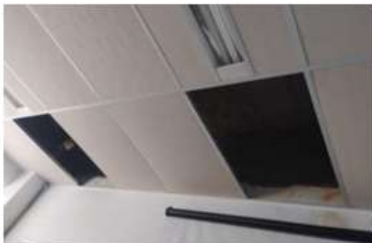
(d) Infiltração na Laje e Forro
