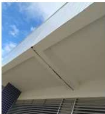
(a) Infiltração na Junta de Dilatação das Vigas
