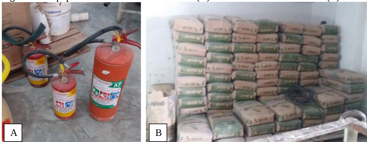
Figura 28 - Equipamentos de combate a incêndio (A) e Pilhas de sacos de cimento (B)
