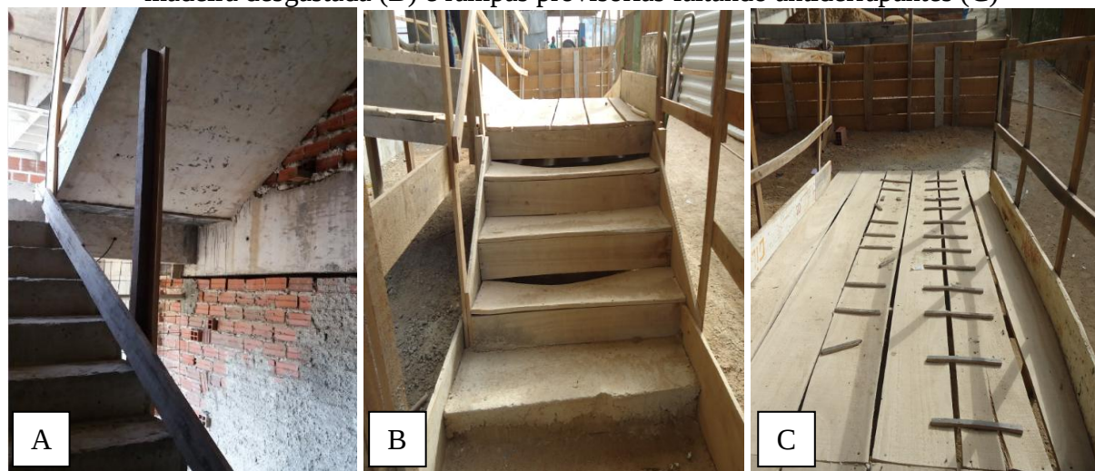
Figura 53 - Escada permanente sem travessa superior do corrimão (A), escada provisória com madeira desgastada (B) e rampas provisórias faltando antiderrapantes (C)
