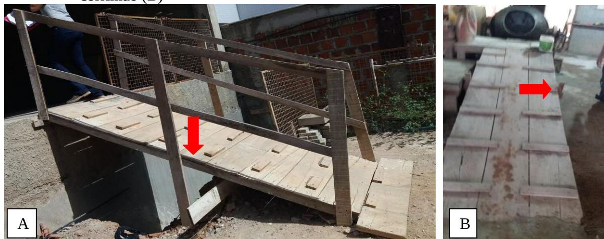
Figura 9 - Rampa de acesso aos banheiros sem rodapé (A), rampa de acesso à betoneira sem corrimão (B)
