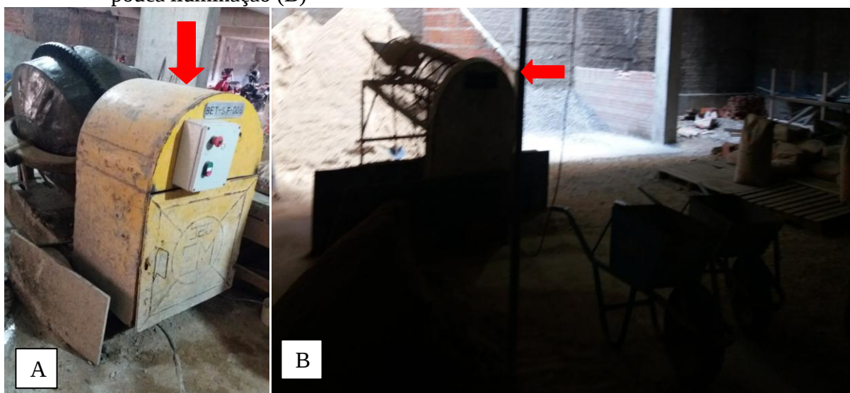
Figura 12 - Proteção da parte móvel e motor da betoneira (A) e Peneira elétrica em local com pouca iluminação (B)
