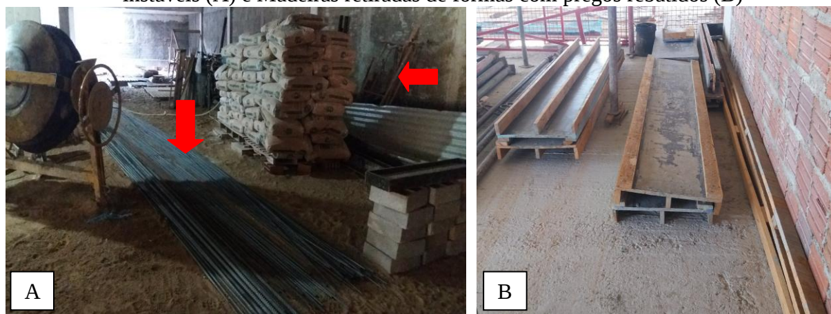
Figura 13 - Vergalhões armazenados nas vias de circulação e pilhas de sacos de cimento instáveis (A) e Madeiras retiradas de formas com pregos rebatidos (B)
