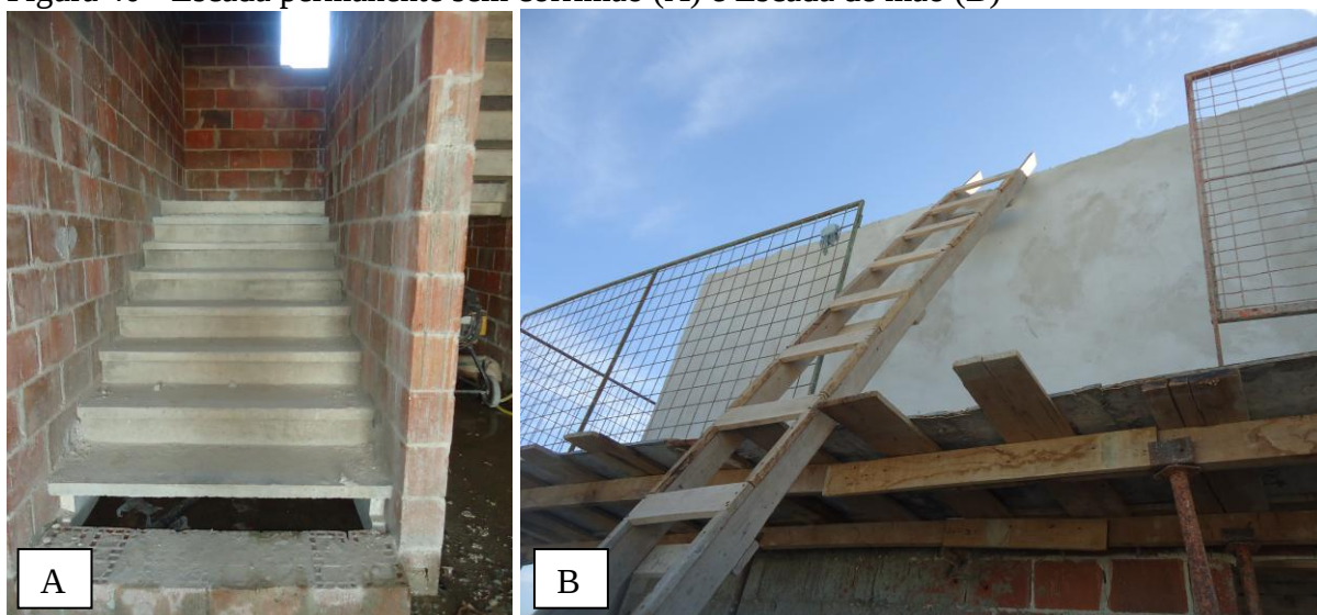
Figura 40 - Escada permanente sem corrimão (A) e Escada de mão (B)
