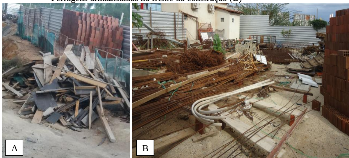
Figura 60 - Madeiras para descarte jogadas de forma errada na lateral do canteiro (A) e Ferragens armazenadas na frente da construção (B)
