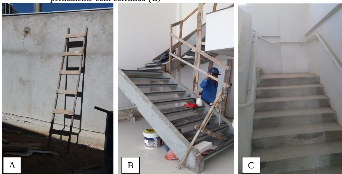
Figura 23 - Escada de mão (A), Escada permanente sem corrimão e rodapé (B) e Escada permanente com corrimão (C)
