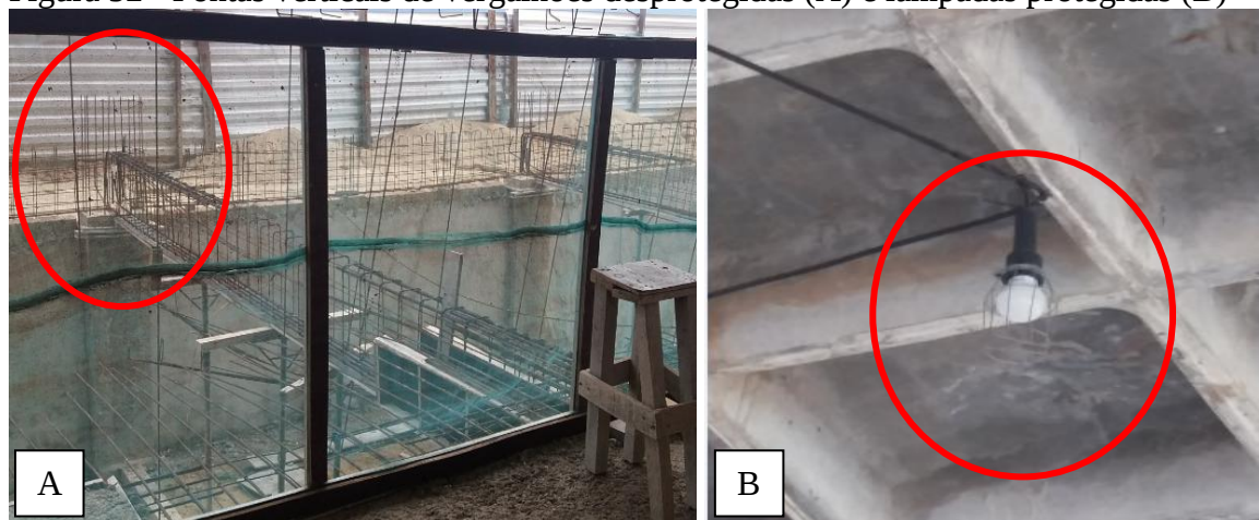
Figura 52 - Pontas verticais de vergalhões desprotegidas (A) e lâmpadas protegidas (B)
