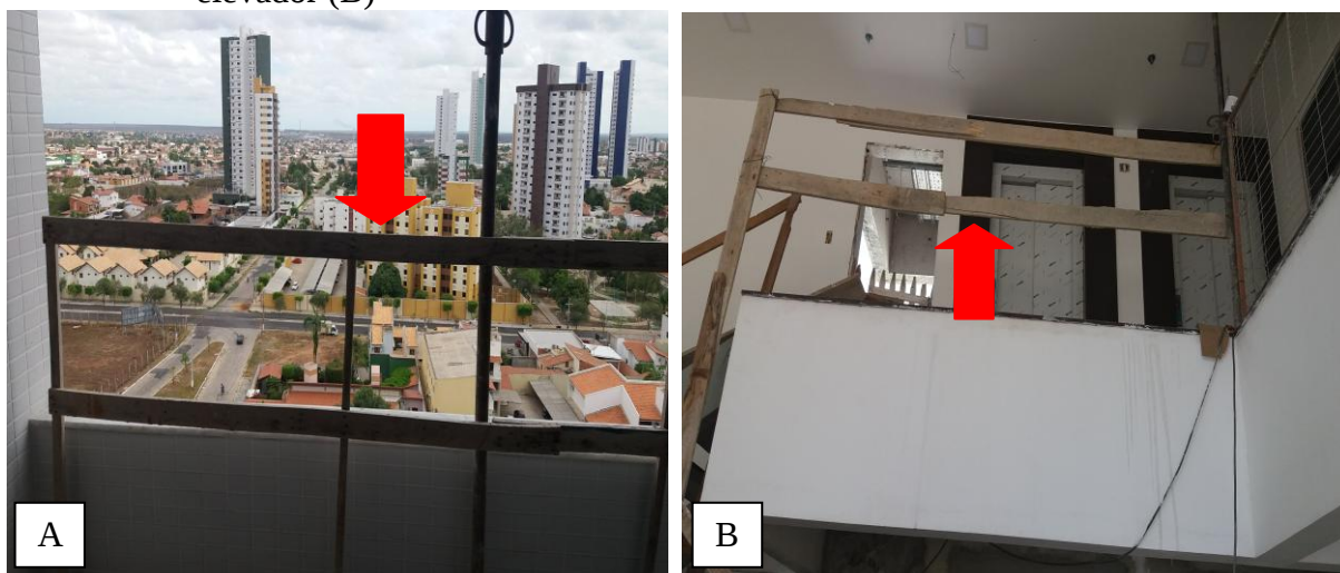
Figura 24 - Peitoril da varanda de um apartamento (A) e Peitoril da circulação próximo ao elevador (B)
