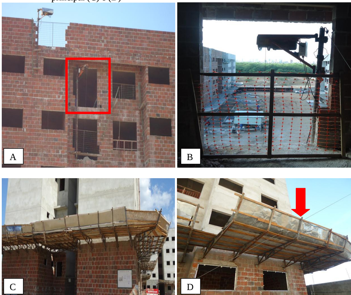
Figura 41 - Abertura para transporte vertical de materiais sem guarda corpo fixo (A), com guarda corpo fixo sem fechamento tipo cancela ou similar (B) e plataforma principal (C) e (D)
