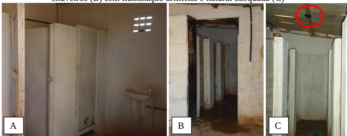
Figura 34 - Banheiro com apenas um lavatório e iluminação insuficiente (A) e área dos chuveiros (B) sem iluminação artificial e natural adequada (C)
