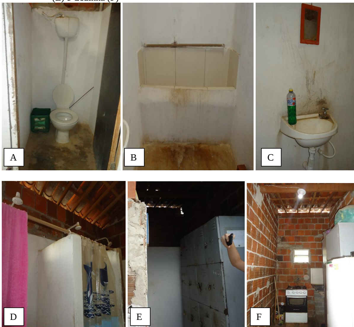
Figura 49 - Vaso sanitário (A), mictório (B), lavatório (C), chuveiros (D), armário individual (E) e Cozinha (F)
