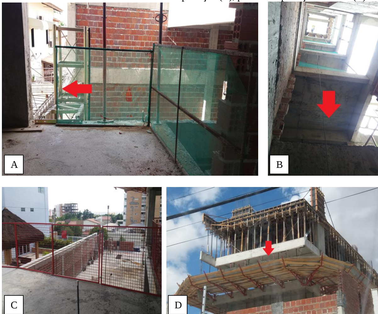
Figura 10 - Proteção coletiva do Obra 1: Local com risco de queda sem guarda corpo (A), entrada e saída de materiais sem proteção (B), peitoril de proteção fechado (C)
