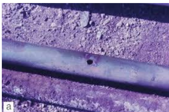
Figura 3: Corrosão eletrolítica em tubos de aço-carbono.
