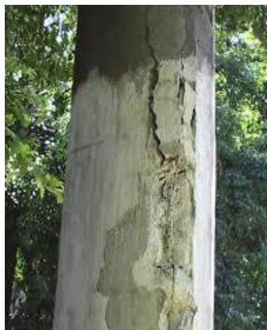
Figura 2: Corrosão química em um poste de concreto armado.
