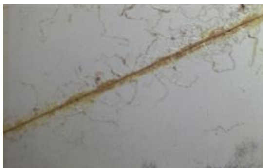
Figura 10: Corrosão Filiforme-filamentos em torno do risco na chapa de aço-carbono pintada.
