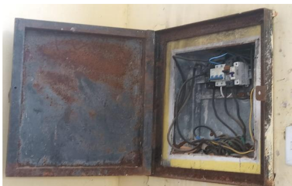
(c) Quadro de distribuição - Área interna.
