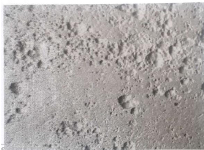
Figura 7: Corrosão por pites em aço inoxidável.
