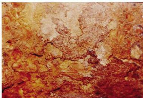
Figura 4: Corrosão uniforme em chapa de aço-carbono.
