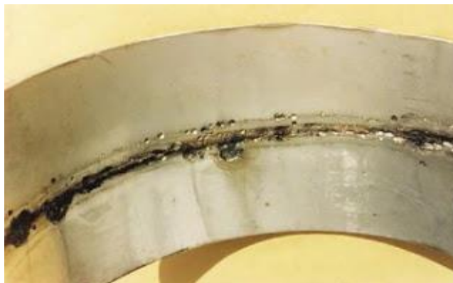
Figura 15: Corrosão em torno do cordão de solda em tubulação de aço inoxidável.
