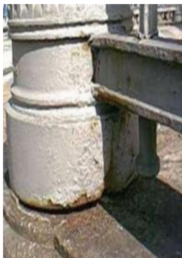
Figura 1: Corrosão eletroquímica, decorrente da exposição atmosférica.
