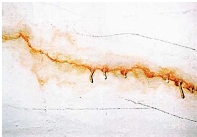
Figura 1: Mancha por excesso de umidade.
