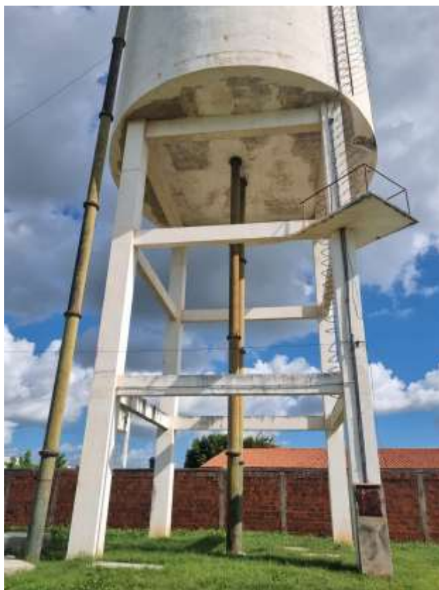
Figura 010 – Carbonatação do concreto
