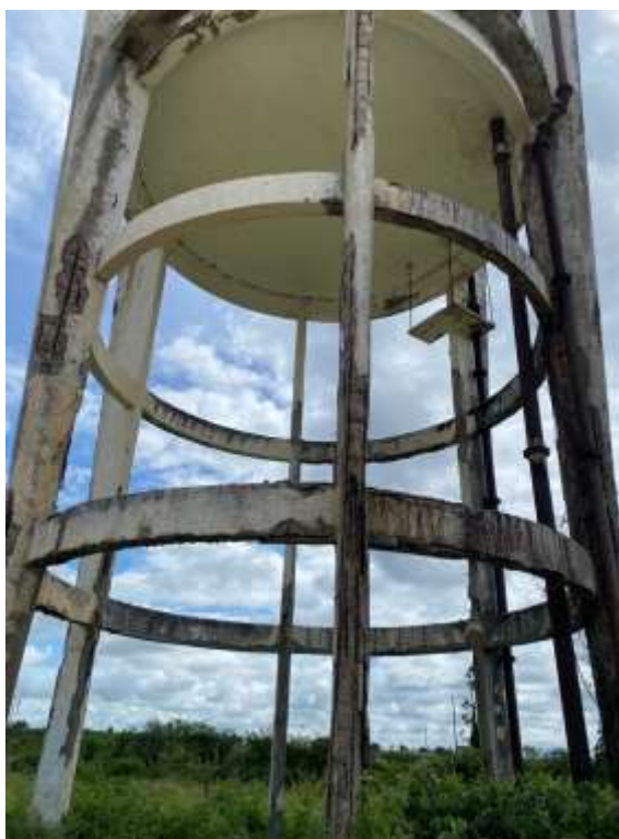
Figura 08 Deslocamento do concreto, fissuração e exposição das armaduras no pilar.
