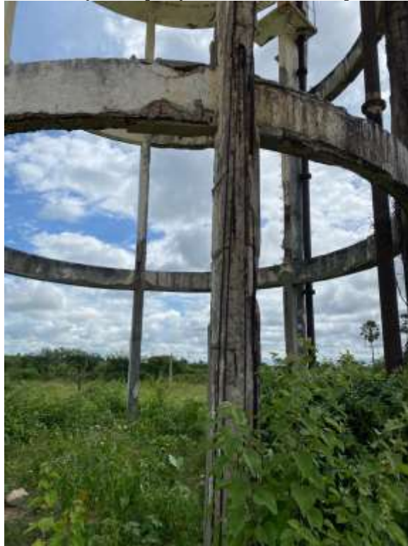
Figura 09 - Deslocamento do concreto, fissuração e exposição das armaduras no pilar.
