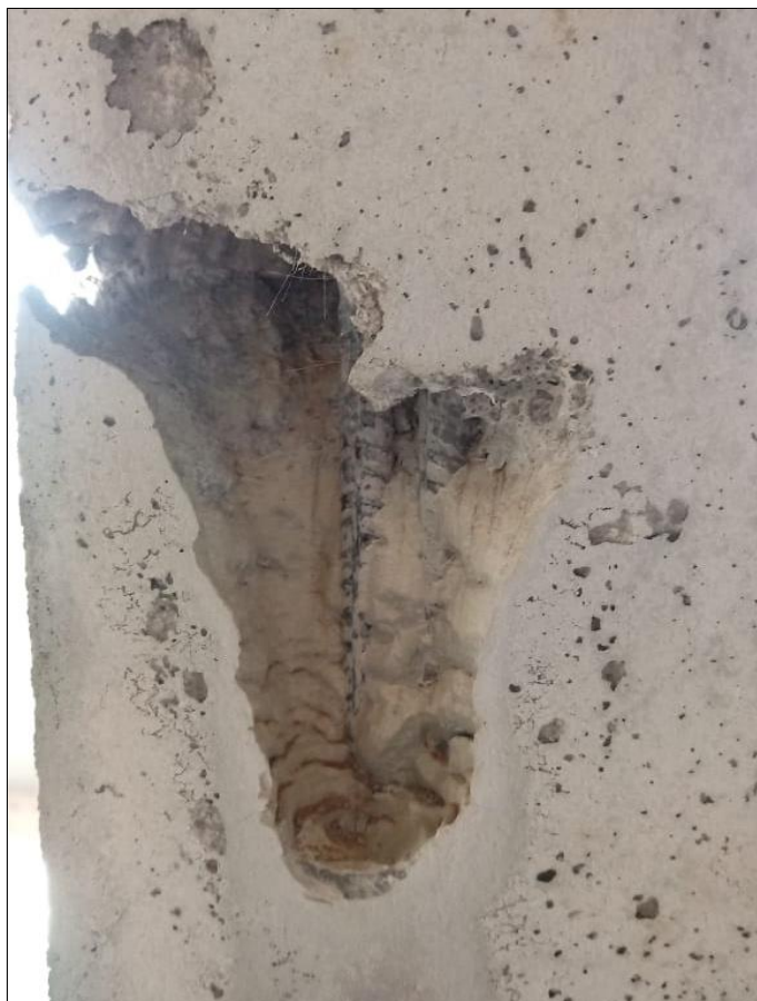
Figura 26: Nicho próximo a vão de porta com exposição de armadura
