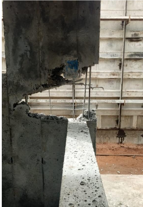
Figura 24: Falha de concretagem próximo a vão de porta com armadura exposta
