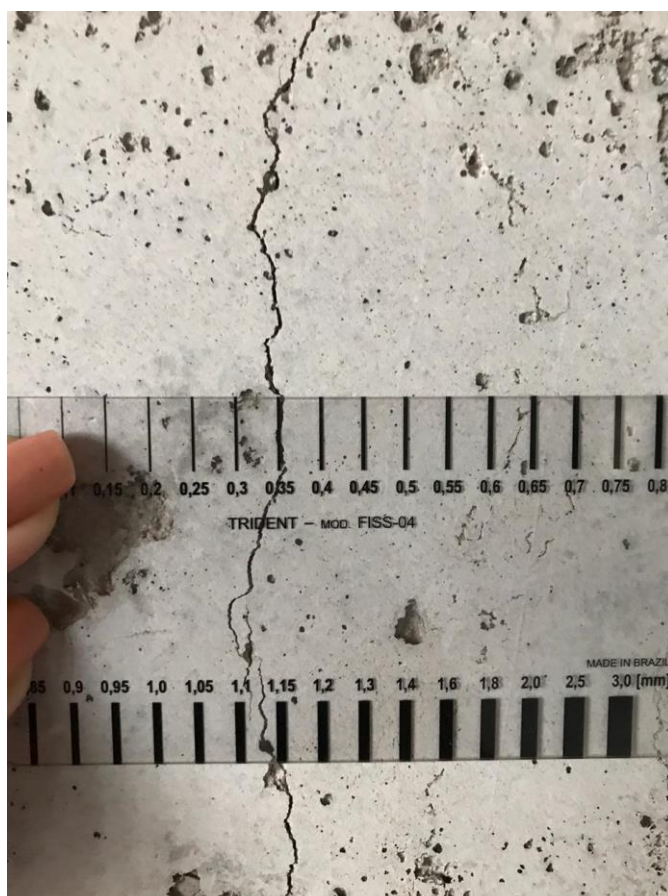
Figura 31: Identificação e medição de fissura em parede de concreto – 0,35 mm
