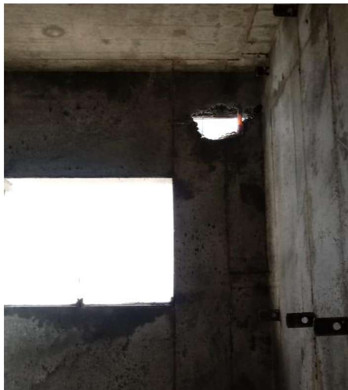
Figura 25: Nicho em parede do banheiro com exposição de eletroduto e armação
