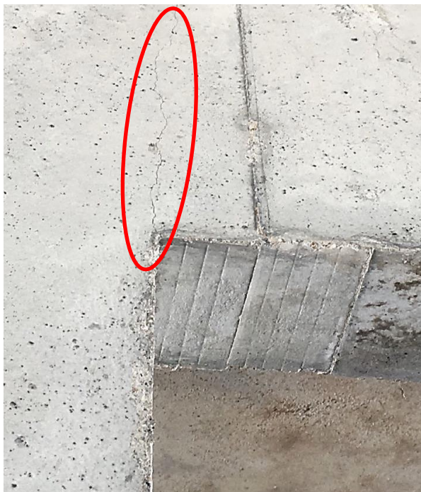
Figura 32: Fissura na parte superior do vão da porta
