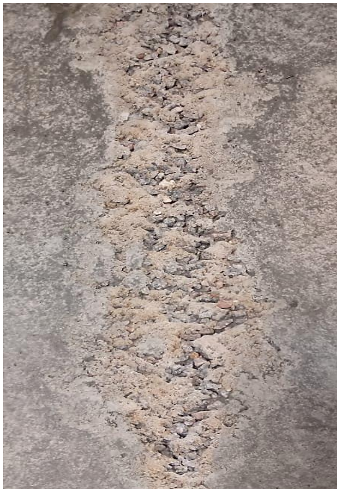
Figura 30: Segregação dos materiais do concreto
