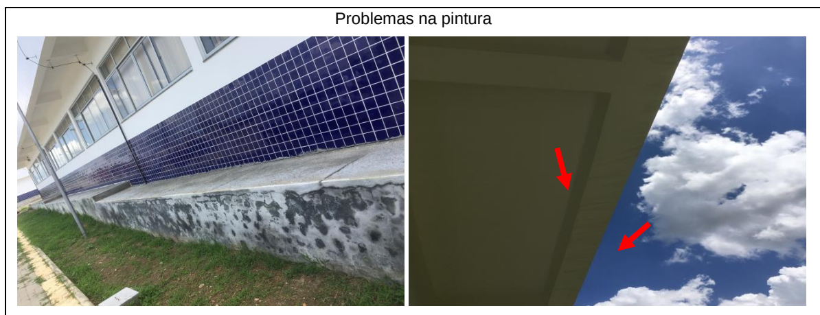
Quadro 8 - Imagens das manifestações patológicas na pintura em alguns pontos do BSPI
