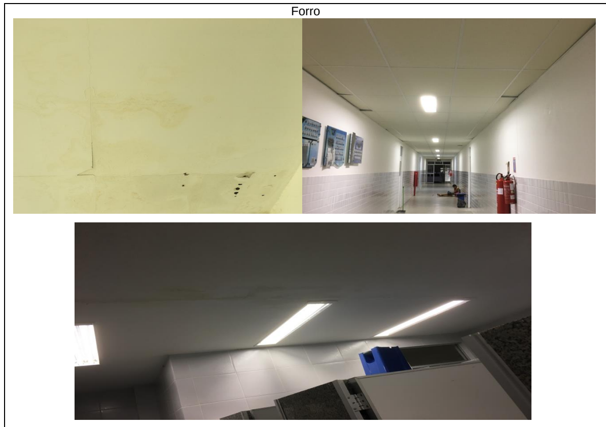
Quadro 4 - Imagens dos problemas no forro do BSA A
