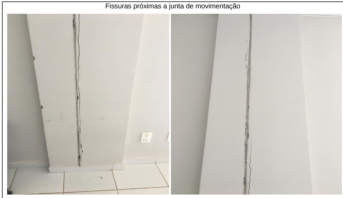
Quadro 7 - Imagens das fissuras no revestimento do pilar no Hall de Entrada do BSPI
