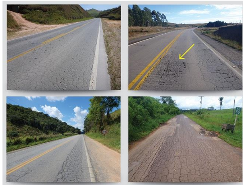
Figura 14: Trinca tipo couro de jacaré
