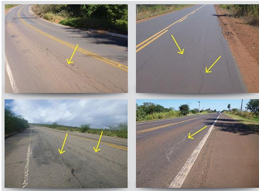
Figura 11: Trincas longitudinais longas
