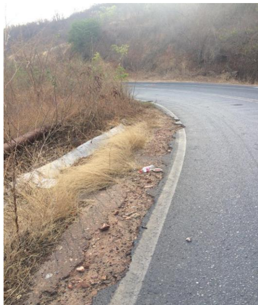
Figura 68: Sujeira ocupando sarjeta
