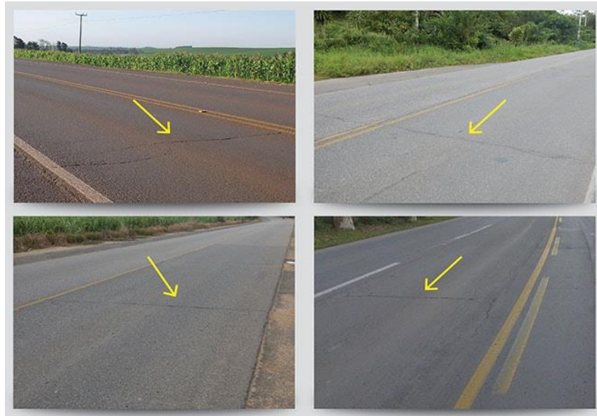
Figura 12: Trinca longitudinal longa
