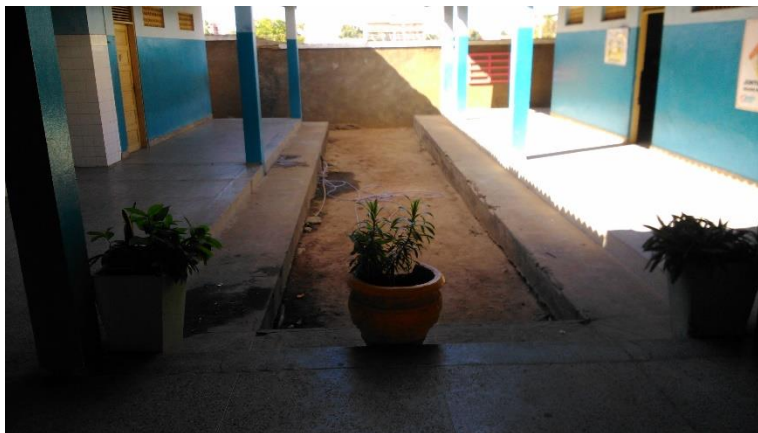
Figura 3 – Perigo de acidente no pátio interno da EM Monsenhor Mota. Fonte: Autoria própria (2019).
