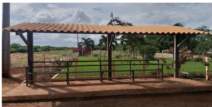
Figura 14 - Telha de fibrocimento instalada em abrigo de ônibus na BR 304 km 1 - RN
