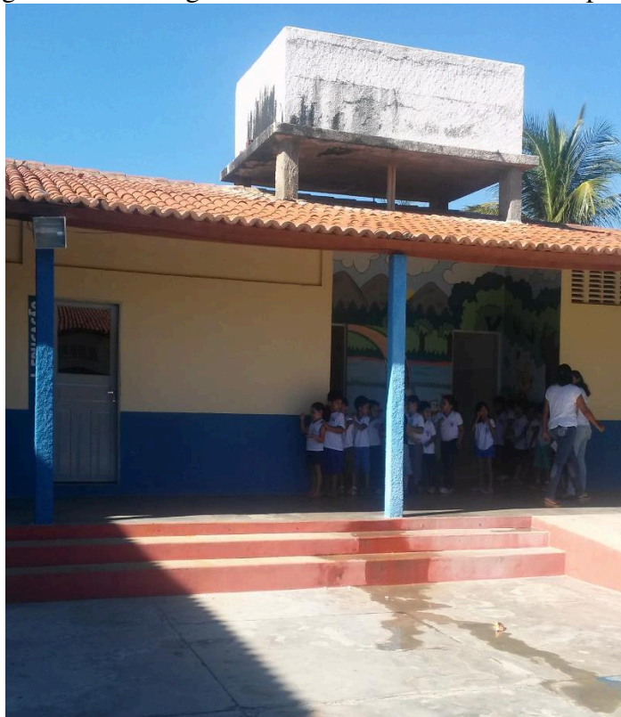
Figura 14 - Patologias encontradas no reservatório superior
