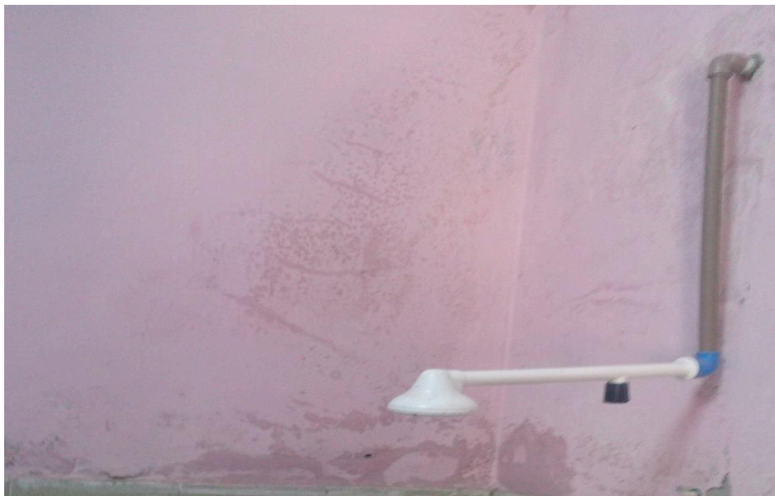
Figura 15 - Patologias encontradas no banheiro dos funcionários/cozinha
