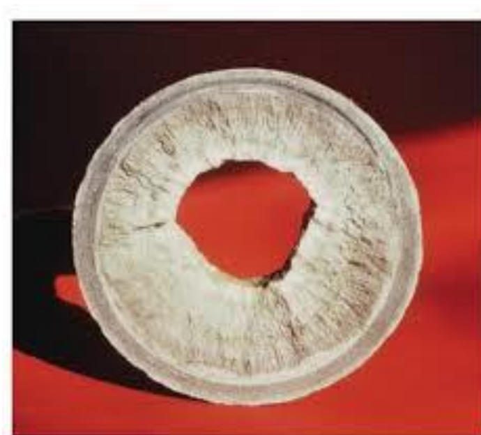
Figura 6 - Incrustação por carbonato de cálcio em uma tubulação
