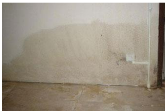
Figura 4 – Manchas de umidade em parede
