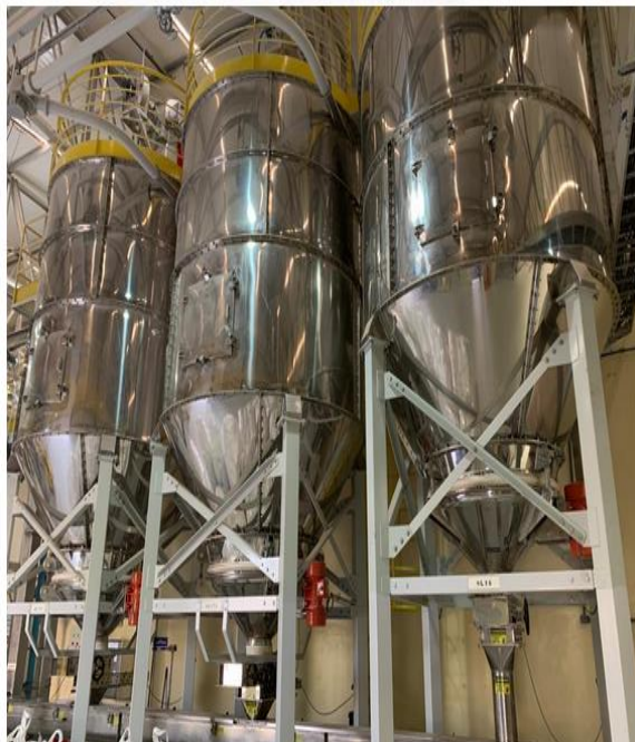
Figura 32: Silos para armazenamento final
