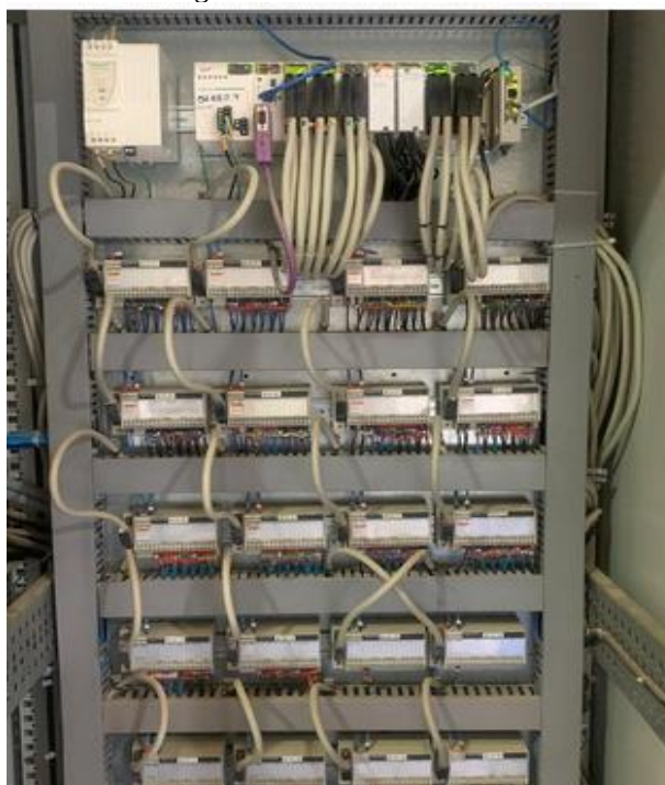
Figura 31: Painel de comando
