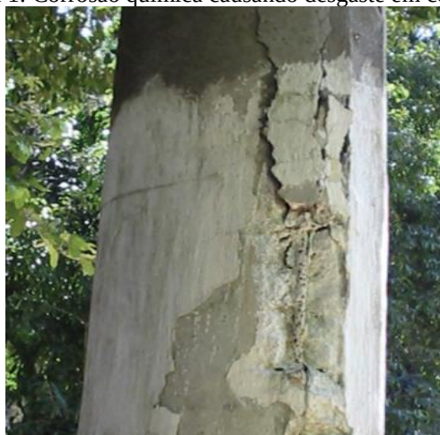
Figura 1: Corrosão química causando desgaste em concreto.
