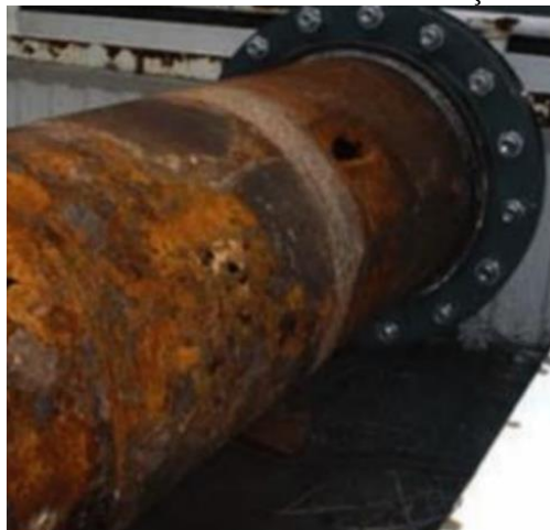
Figura 2: Corrosão eletrolítica em uma tubulação industrial.
