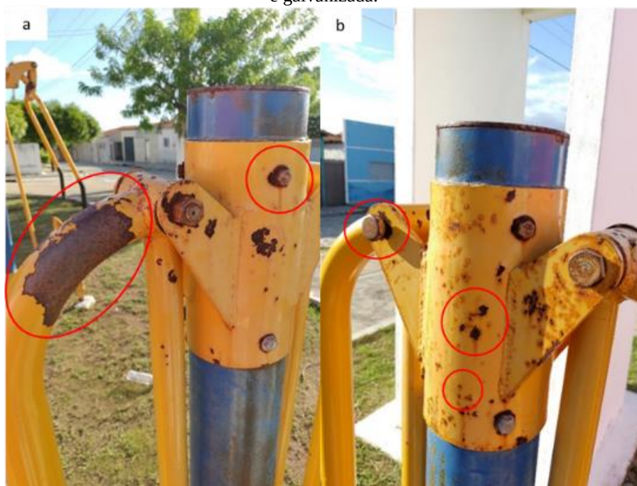
Figura 37: Equipamento de pressão de pernas duplo, a) região superior do lado esquerdo do assento com corrosão uniforme e galvanizada, b) região superior do lado direito do assento com corrosão uniforme, por pites e galvanizada.
