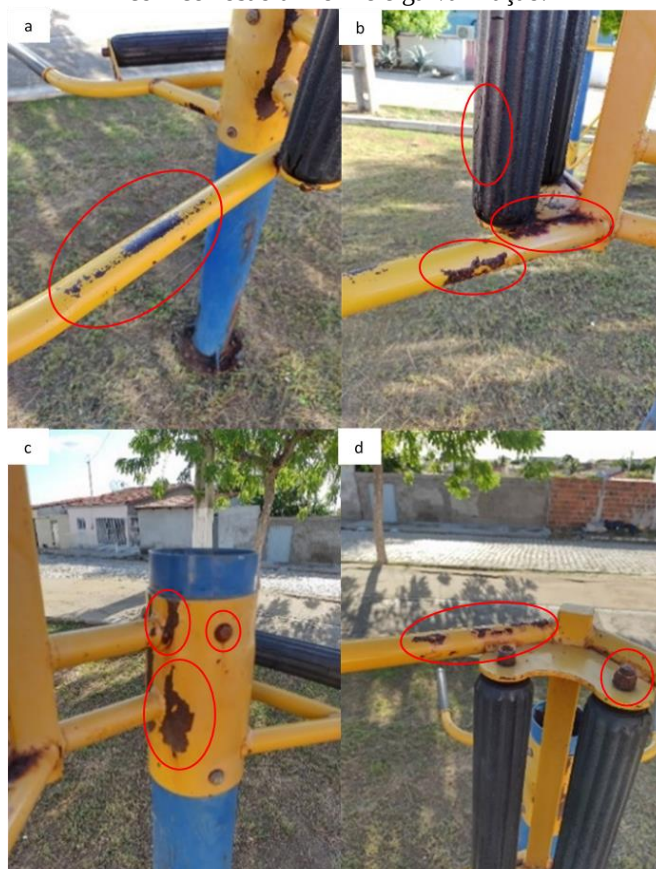
Figura 40: Equipamento massageador duplo, a) região posterior do lado direito com corrosão uniforme, b) região posterior do lado esquerdo com corrosão uniforme e em torno do cordão de solda, c) região da base do lado direito com corrosão uniforme, galvanização e em torno do cordão de solda, d) região superior do equipamento com corrosão uniforme e galvanização.
