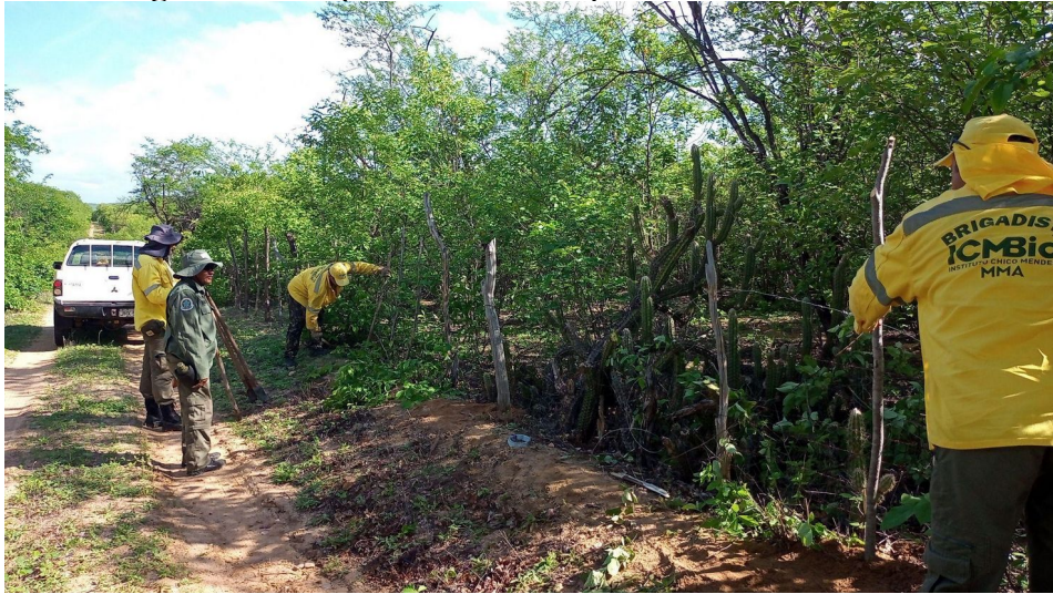
Figura 29 – Reparos nas cercas que delimitam a FLONA.
