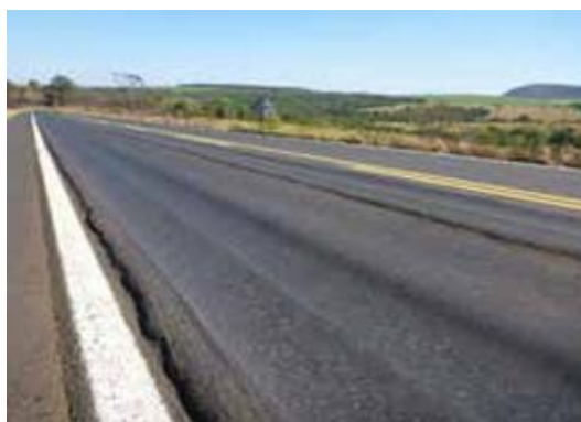
Figura 7 – Afundamento plástico nas trilhas de roda
