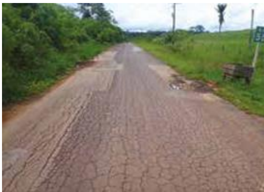
Figura 5: Trinca tipo "couro de jacaré"
