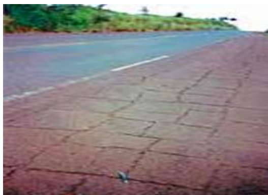
Figura 6 – Trinca tipo "bloco"
