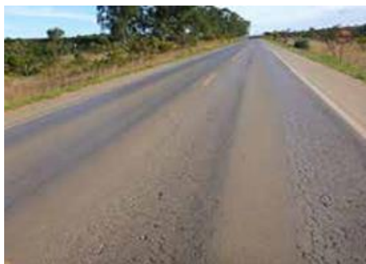
Figura 8 – Afundamento por consolidação nas trilhas de roda
