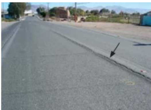
Figura 4 – Trinca de retração
