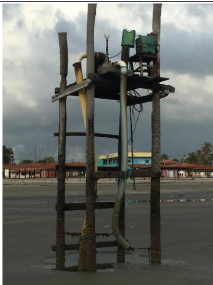
Figura 5. Bomba de água instalada em um altar acima do nível da maré. Fonte: Autoria própria.
