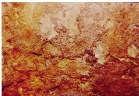
Corrosão uniforme em chapa de aço-carbono.
