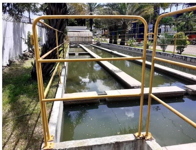
Figura 3 – Um exemplo de estação de tratamento de efluentes
